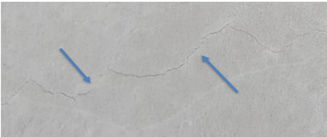
Figura N° 10: Fisuras por contracción plástica en vereda. Fuente: Captura obtenida en campo. Elaboración propia. (2022)
