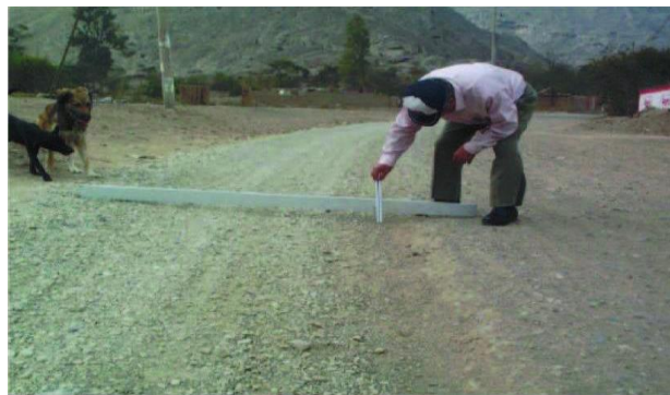
Figura N°22: Hundimientos entre 5 cm y 10 cm
