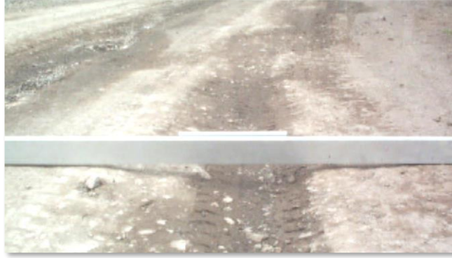
Figura N°25: Gravedad 2: profundidad entre 5 cm y 10
