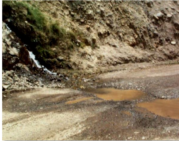
Figura N°32: Cruce de agua
