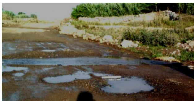
Figura N°29: Gravedad 3: necesita una reconstrucción
