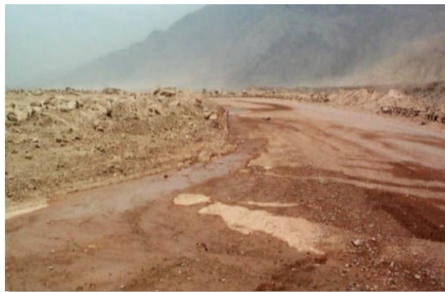
Figura N°28: Necesita una capa de material adicional
