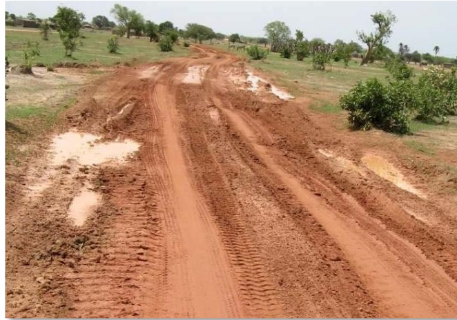
Figura N°5: Hundimiento y Ahuellamiento
