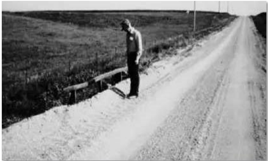
Figura N°3: Pérdida de grava
