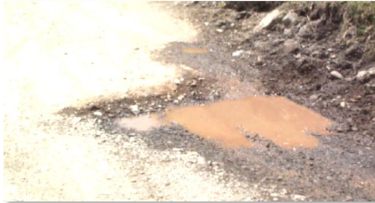
Figura N°27: Gravedad 1: pueden repararse por mantenimiento rutinario
