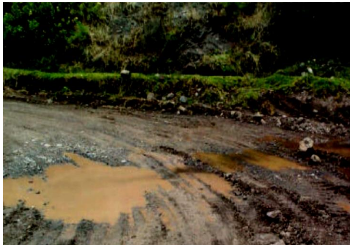
Figura N°31: Lodazal-MTC Fuente: Manual de Carreteras Mantenimiento o Conservación Vial., 2014. (pág. 81).
