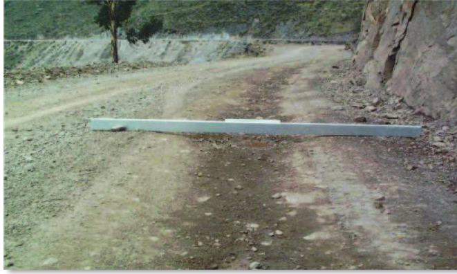
Figura N°23: Hundimientos \geq 10 cm
