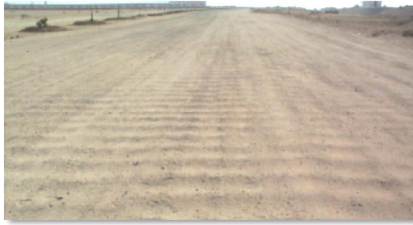
Figura N°30: Gravedad 1: sensible al usuario, pero < 5 cm Fuente: Manual de Carreteras Mantenimiento o Conservación Vial. (2014, pág. 80).
