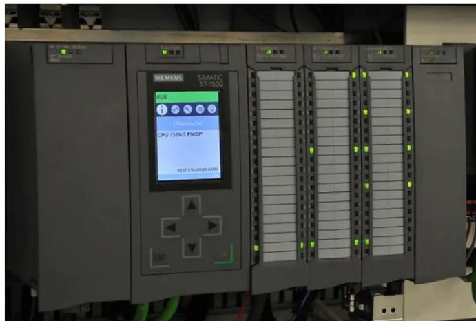
Figura 6 PLC marca Siemens modelo S7-1500 conectado a diversos módulos.
