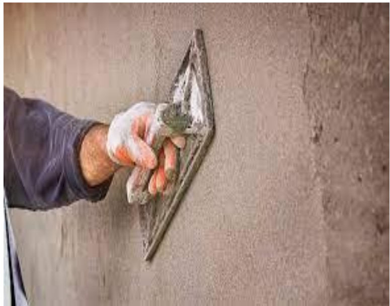
Figura 29 : Revestimiento de muro
