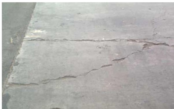
Figura 39. Gravedad 3: Abiertas y ramificadas con pérdida de material. Fuente: MTC (2016)
