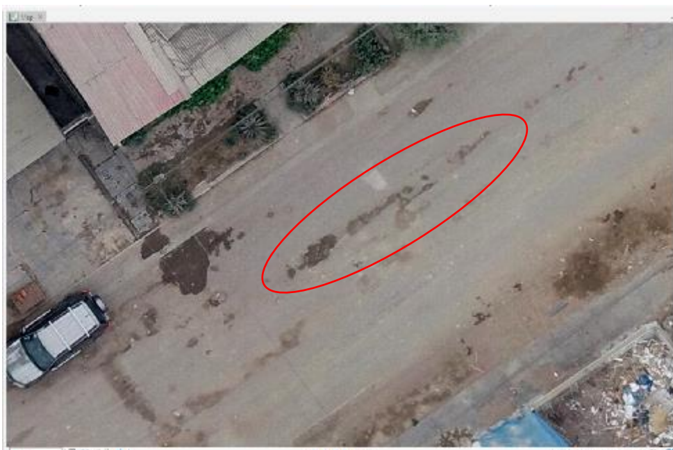
Figura 88. Vista de planta de una falla en ArcgisPro. Fuente: Elaboración propia usando ArcgisPro ®.
