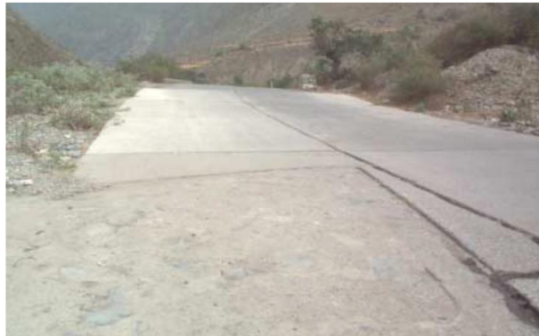
Figura 46. Gravedad 3: Continúas (más que el 30% de la superficie de la losa afectada). Fuente: MTC (2016).
