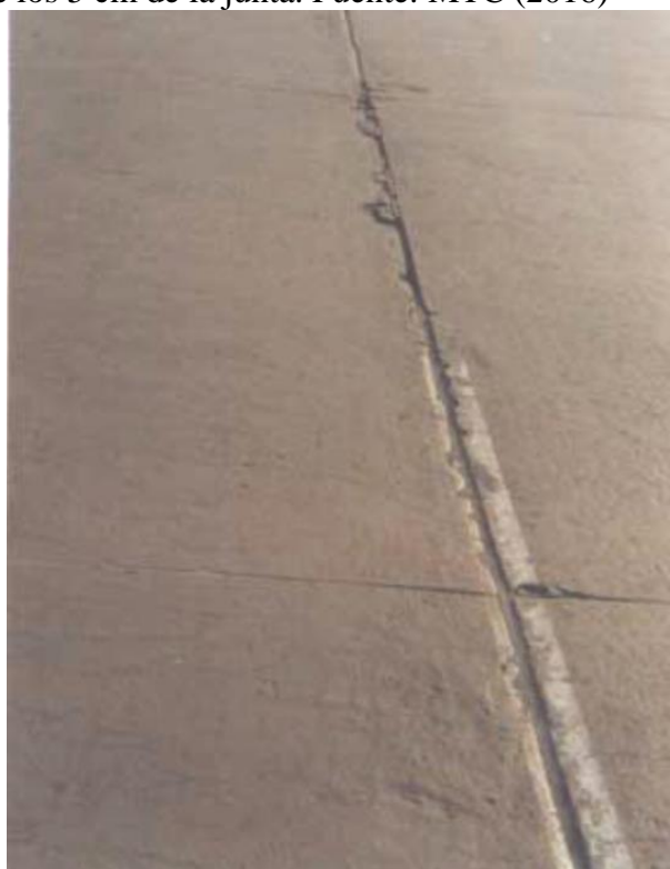
Figura 49. Gravedad 3: Fracturamiento o desintegración hasta una distancia superior a 5 cm de la junta. Fuente: MTC (2016)
