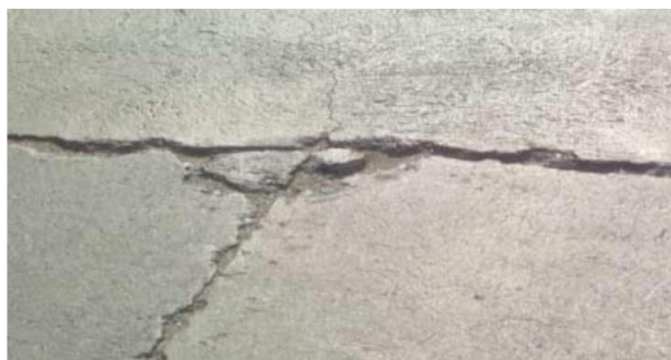
Figura 40. Gravedad 2: Dos esquinas quebradas. Fuente: MTC (2016)
