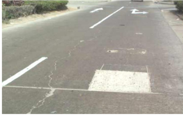
Figura 44. Gravedad 1: Puntuales (menos que el 10% de la superficie). Fuente: MTC (2016)
