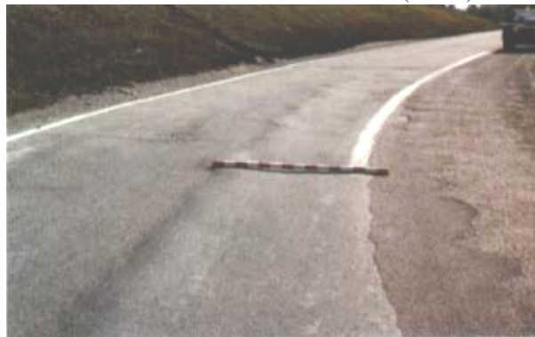
Figura 17. Gravedad 2: Profundidad \geq 1 cm. Se observa un levantamiento de materiales formando cordones a lo largo del trazado de las ruedas. Fuente: MTC (2016)
