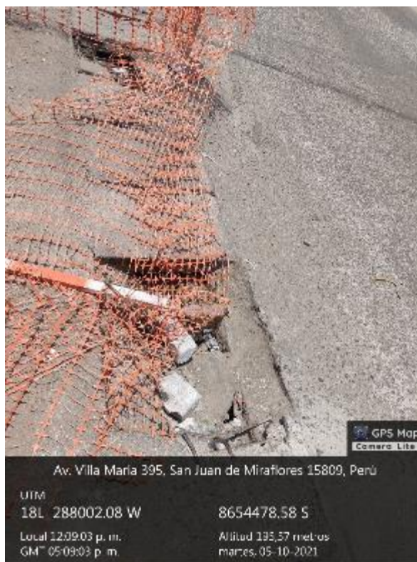
Figura 97.. Falla en la cuadra 4 de la Av. Villa María. Fuente: Elaboración propia.
