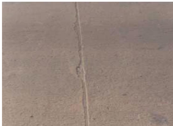
Figura 47. Gravedad 1: Fracturamiento o desintegración de bordes en menos que el 50 % de la longitud dentro de los 5 cm de la junta. Fuente: MTC (2016)
