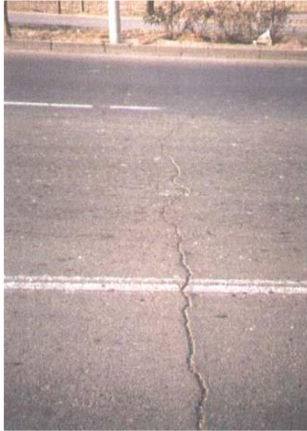
Figura 28. Gravedad 2: Fisuras abiertas y/o ramificadas sin pérdida de material. Fuente: MTC (2016)
