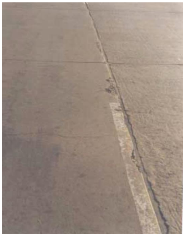
Figura 48. Gravedad 2: Fracturamiento o desintegración de bordes en más que el 50 % de la longitud dentro de los 5 cm de la junta. Fuente: MTC (2016)
