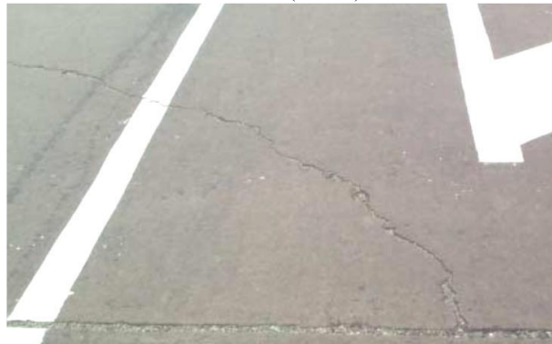
Figura 42. Gravedad 2: Abiertas y/o ramificadas sin pérdida de material. Fuente: MTC (2016).
