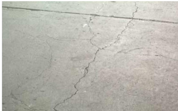
Figura 35. Gravedad 2: Abiertas y/o ramificadas sin pérdida de material. Fuente: MTC (2016)
