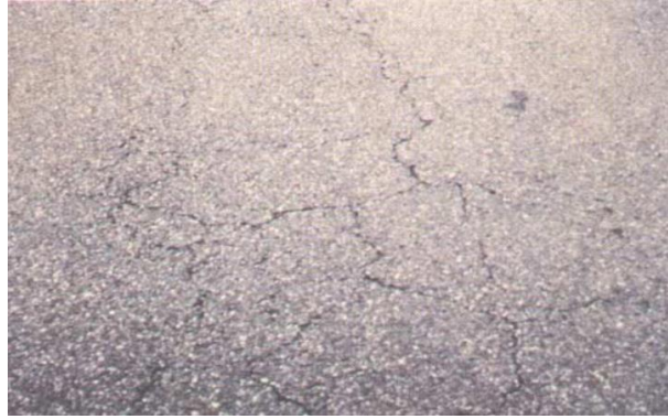
Figura 5. Gravedad 1: Malla Grande (>0.5 mm) sin material suelto. Fuente: MTC (2016).
