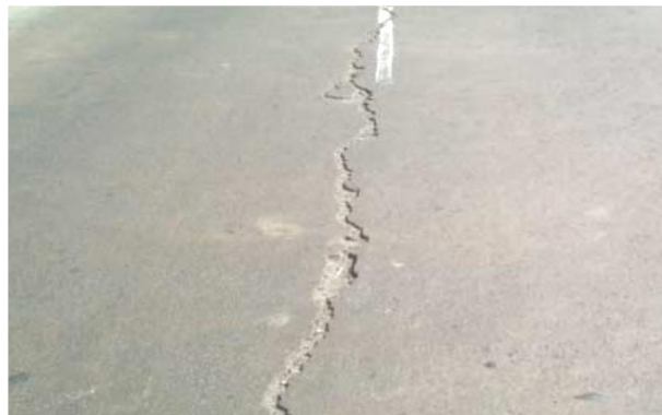
Figura 36. Gravedad 3: Abiertas y ramificadas con pérdida de material. Fuente: MTC (2016)
