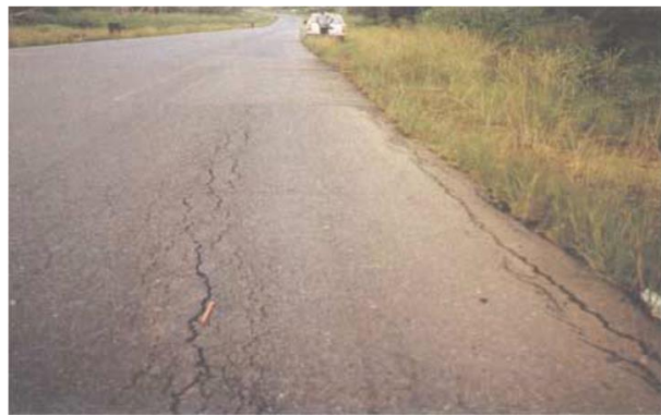
Figura 10. Gravedad 3: Fisuras abiertas y/o ramificadas con pérdida de material. Fuente: MTC (2016)
