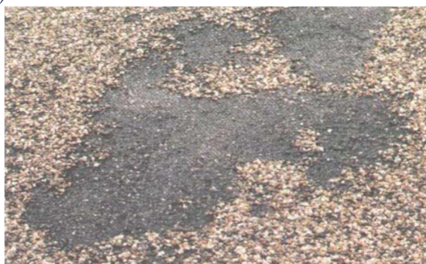
Figura 23. Gravedad 2: Continuo sin aparición de la base granular o puntual con aparición de la base granular. Fuente: MTC (2016)
