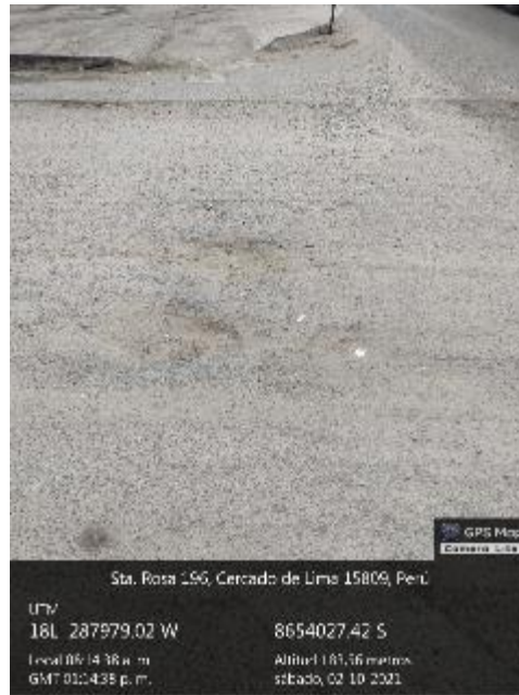
Figura 82. Falla en la cuadra 1 de la Av. Santa Rosa. Fuente: Elaboración propia.
