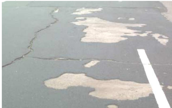
Figura 52. Gravedad 2: Desprendimiento entre el 10% y 50% de la superficie de losa afectada. Fuente: MTC (2016)
