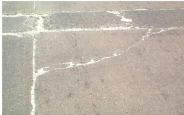
Figura 43. Gravedad 3: Abiertas y ramificadas con pérdida de material. Fuente: MTC (2016).
