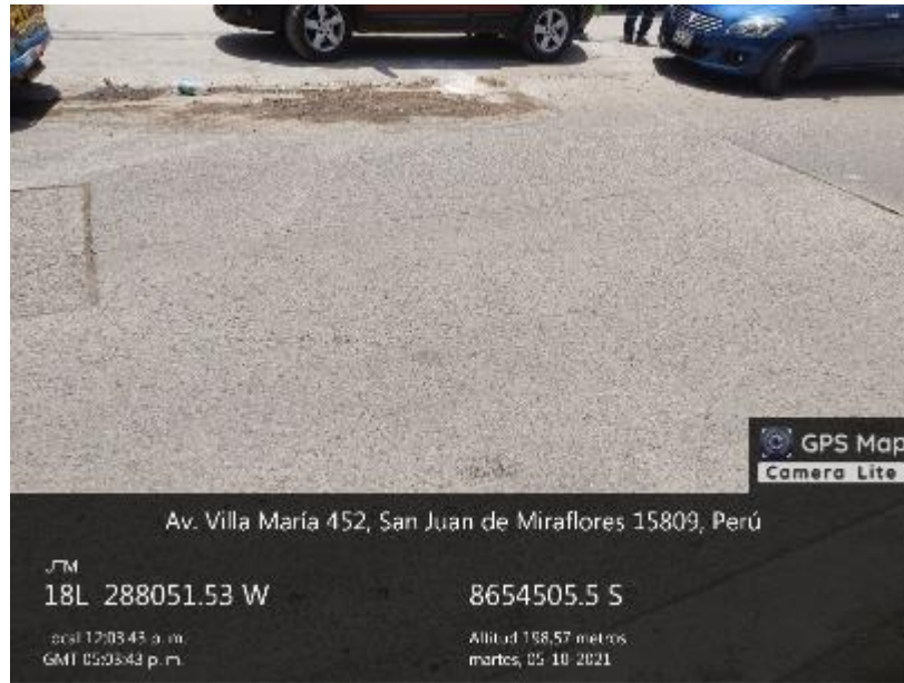
Figura 63. Cuadra 4 de la Av. Villa María. Fisuras longitudinales, oblicuas y transversales. Fuente: Propia con uso de la aplicación GPS Map Camera Lite.
