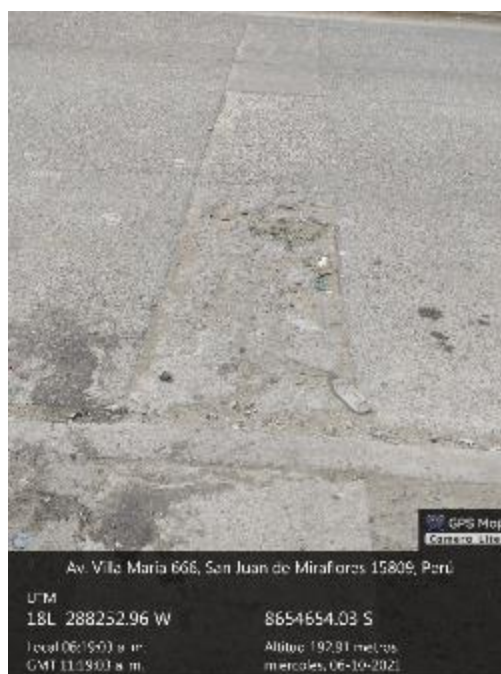
Figura 62. Cuadra 6 de la Av. Villa María. Desprendimiento del bacheo. Fuente: Propia con uso de la aplicación GPS Map Camera Lite.
