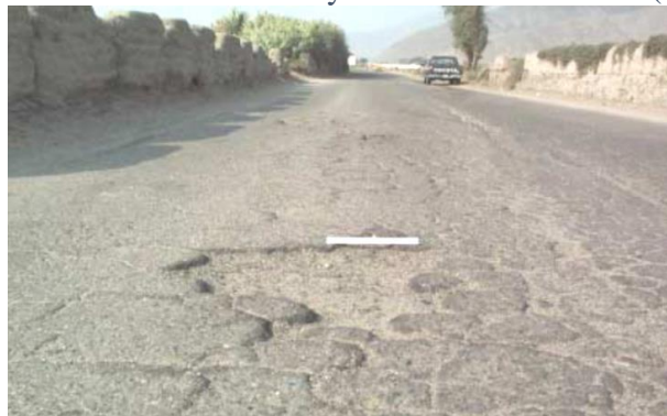
Figura 26. Gravedad 3: Diámetro > 0.5 m. Fuente: MTC (2016)
