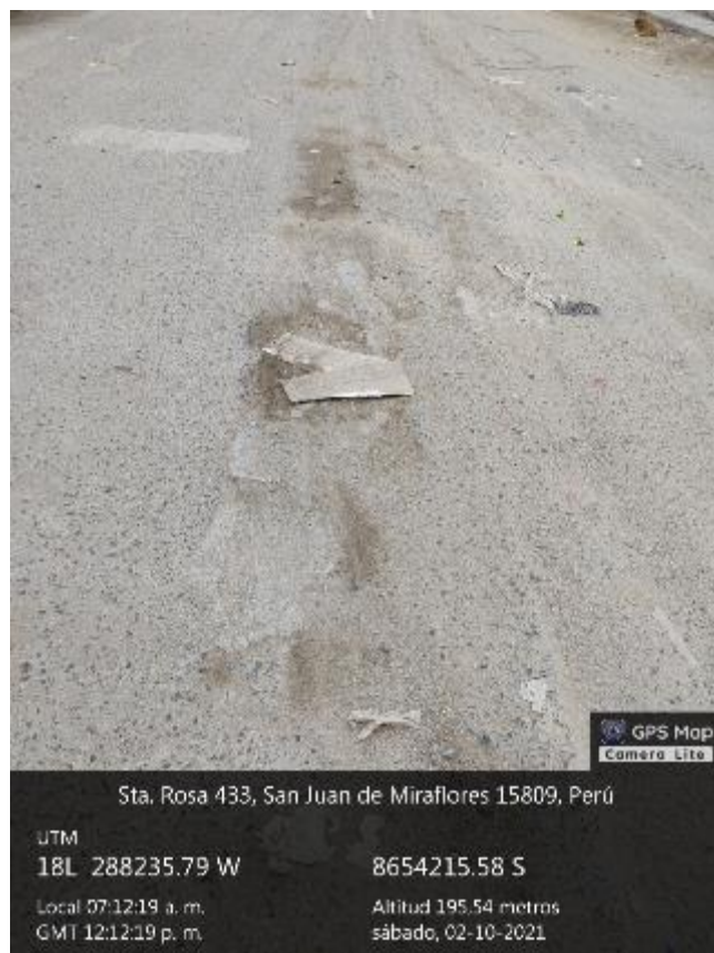
Figura 87. Falla en la cuadra 4 de la Av. Santa Rosa. Fuente: Elaboración propia.
