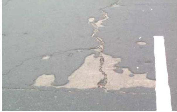
Figura 51. Gravedad 1: Desprendimiento en menos que el 10% de la superficie de losa afectada. Fuente: MTC (2016)
