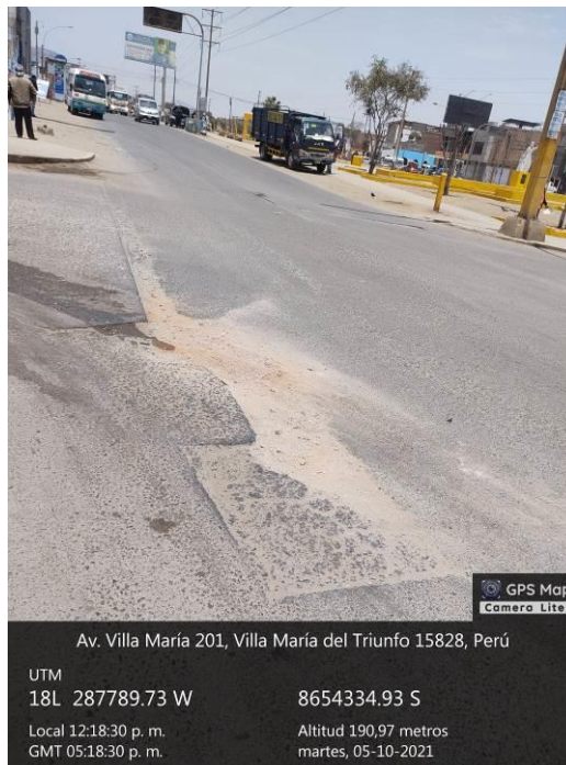
Figura 66. Cuadra 2 de la Av. Villa María. Huevo y daño severo en el pavimento. Fuente: Propia con uso de la aplicación GPS Map Camera Lite.
