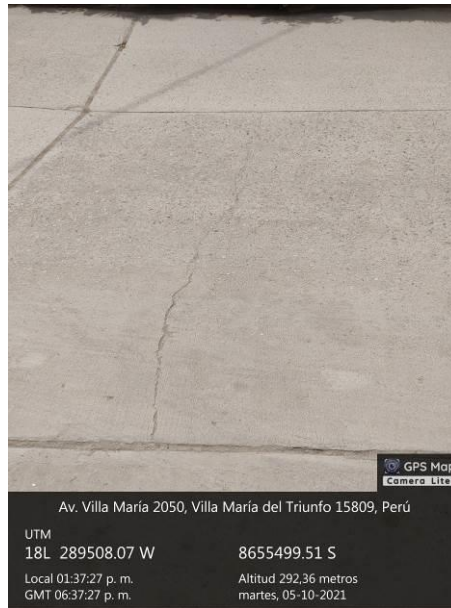
Figura 65. Cuadra 5 de la Av. Villa María. Fisura transversal. Fuente: Propia con uso de la aplicación GPS Map Camera Lite.
