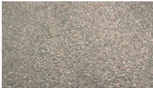
Figura 21. Gravedad 1: Puntual sin aparición de la base granular (tratamiento superficial). Fuente: MTC (2016)
