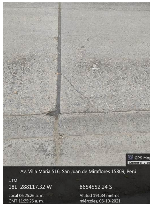
Figura 64. Cuadra 5 de la Av. Villa María. Fisura de esquina. Fuente: Propia con uso de la aplicación GPS Map Camera Lite.
