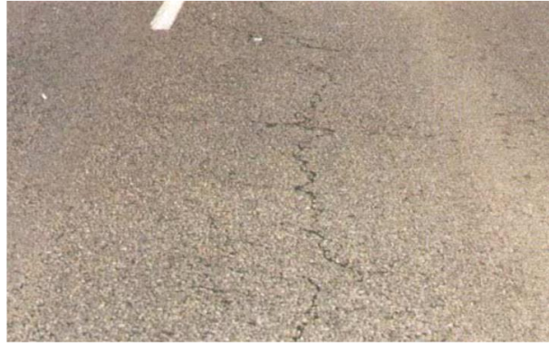
Figura 9. Gravedad 2: Fisuras abiertas y/o ramificadas sin pérdida de material. Fuente: MTC (2016)
