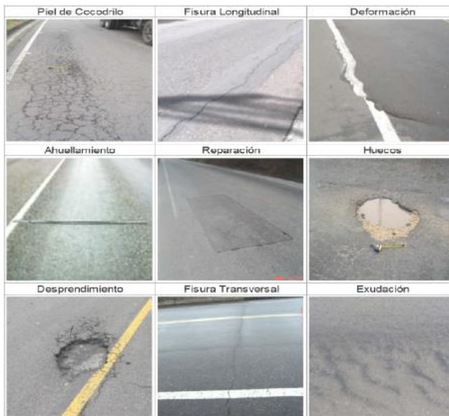
Figura 4. Daños en pavimentos flexibles. Fuente: MTC (2016)
