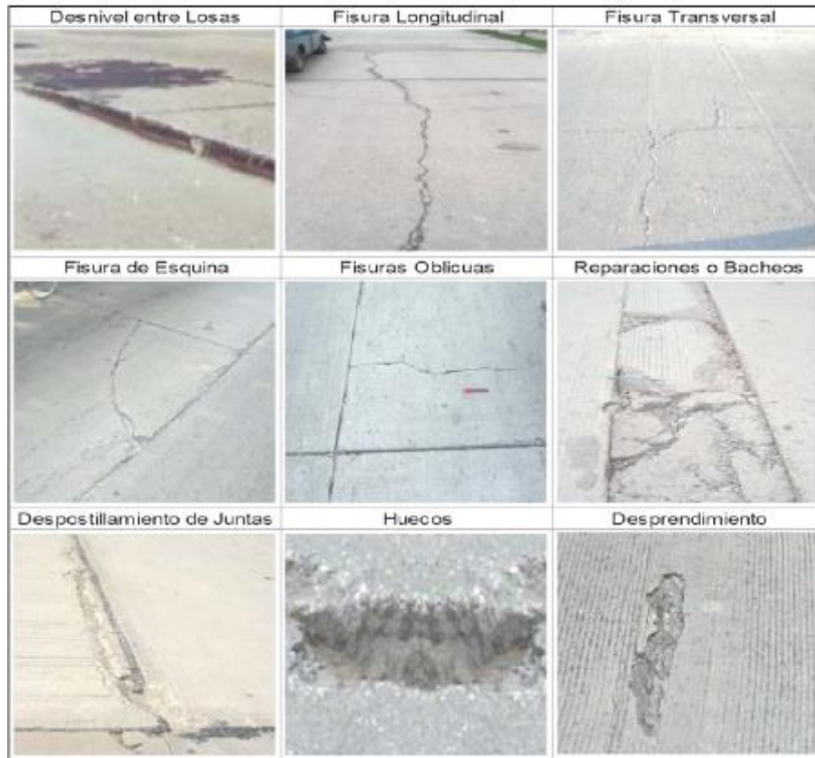
Figura 30. Daños en pavimentos rígidos. Fuente: MTC (2016)
