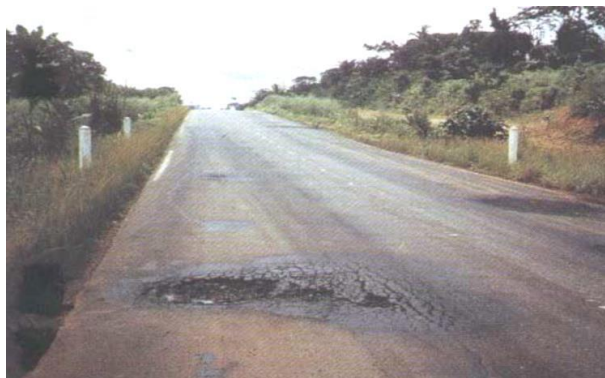
Figura 20. Gravedad 3: Reparación de piel de cocodrilo o de fisuras longitudinales, en mal estado. Fuente: MTC (2016)
