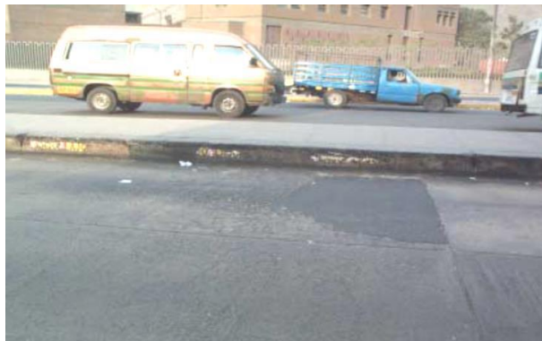
Figura 45. Gravedad 2: Puntuales (entre el 10% y 30% de la superficie de la losa afectada). Fuente: MTC (2016)
