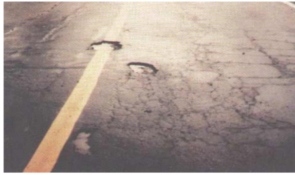
Figura 24. Gravedad 1: Diámetro < 0.2 m. Fuente: MTC (2016)
