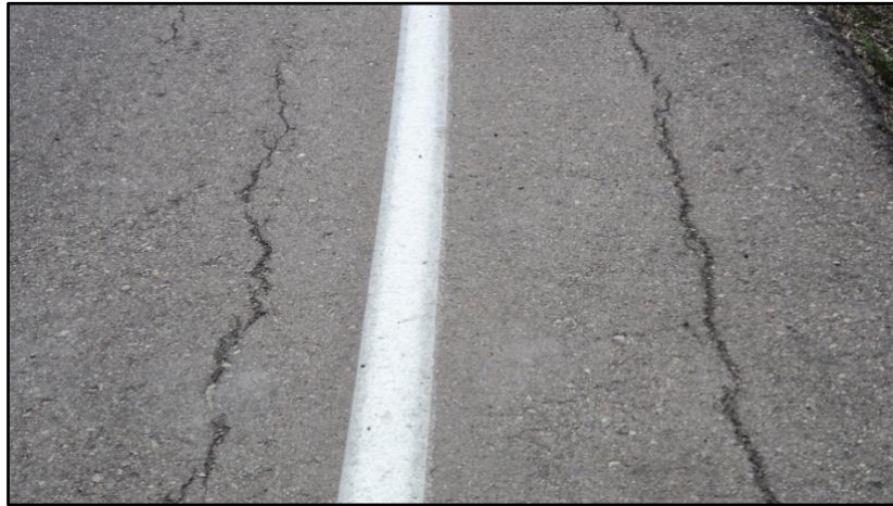
Figura N°3: Fallos en la construcción de pavimentos Fuente: Adaptado de Diseño de Pavimentos I (2010)
