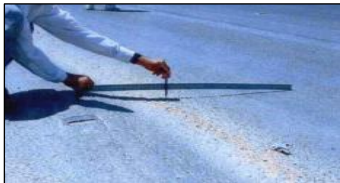
Figura N°9: Deformación plástica 2 en pavimentos asfálticos Fuente: Adaptado de Padilla (2004)
