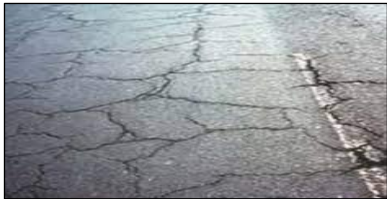
Figura N°7: Agrietamientos y fisuras en pavimentos asfálticos Fuente: Adaptado de Padilla (2004)
