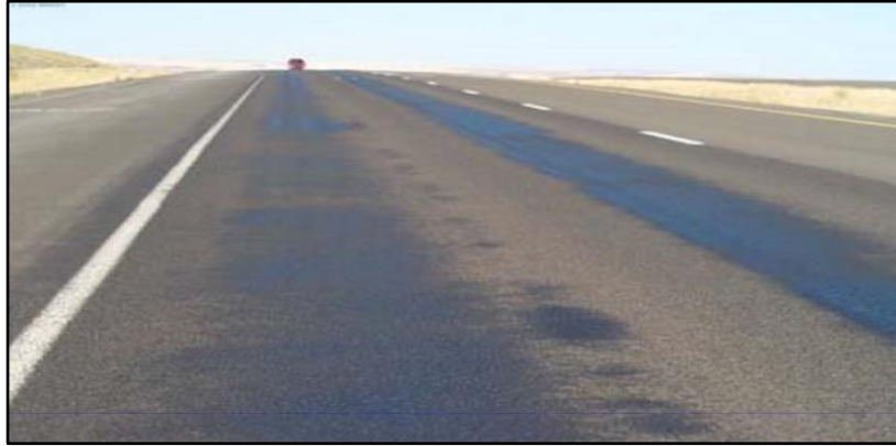
Figura N°5: Exudaciones en pavimentos asfálticos Fuente: Adaptado de Diseño de Pavimentos I (2010).
