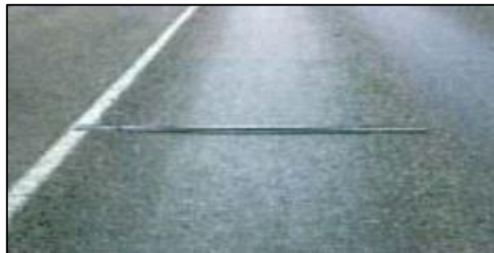
Figura N°8: Deformación plástica 1 en pavimentos asfálticos Fuente: Adaptado de Padilla (2004)
