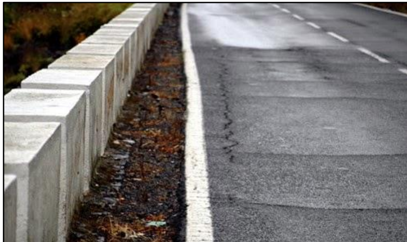
Figura N°4: Fallos en la construcción de pavimentos Fuente: Adaptado de Diseño de Pavimentos I (2010)
