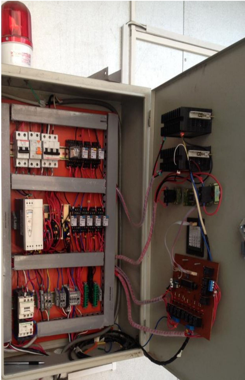
Figura 3.10: Tablero de control eléctrico.
