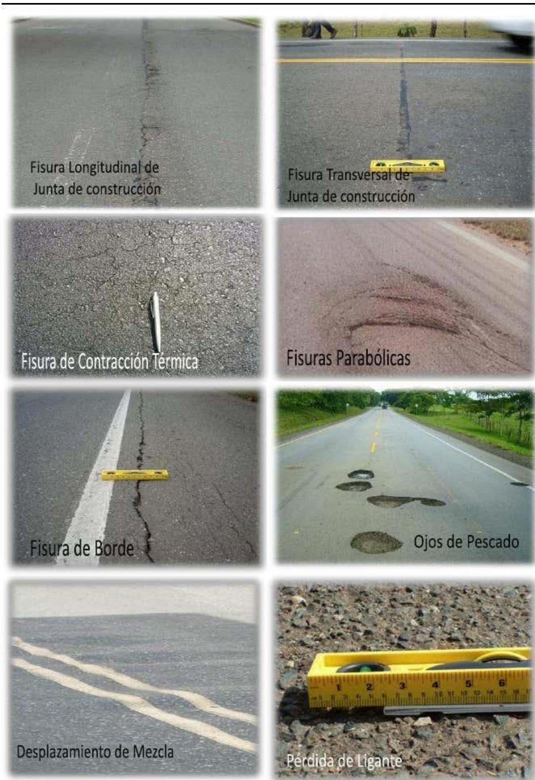
Figura N° 7: Deterioros del tipo B
