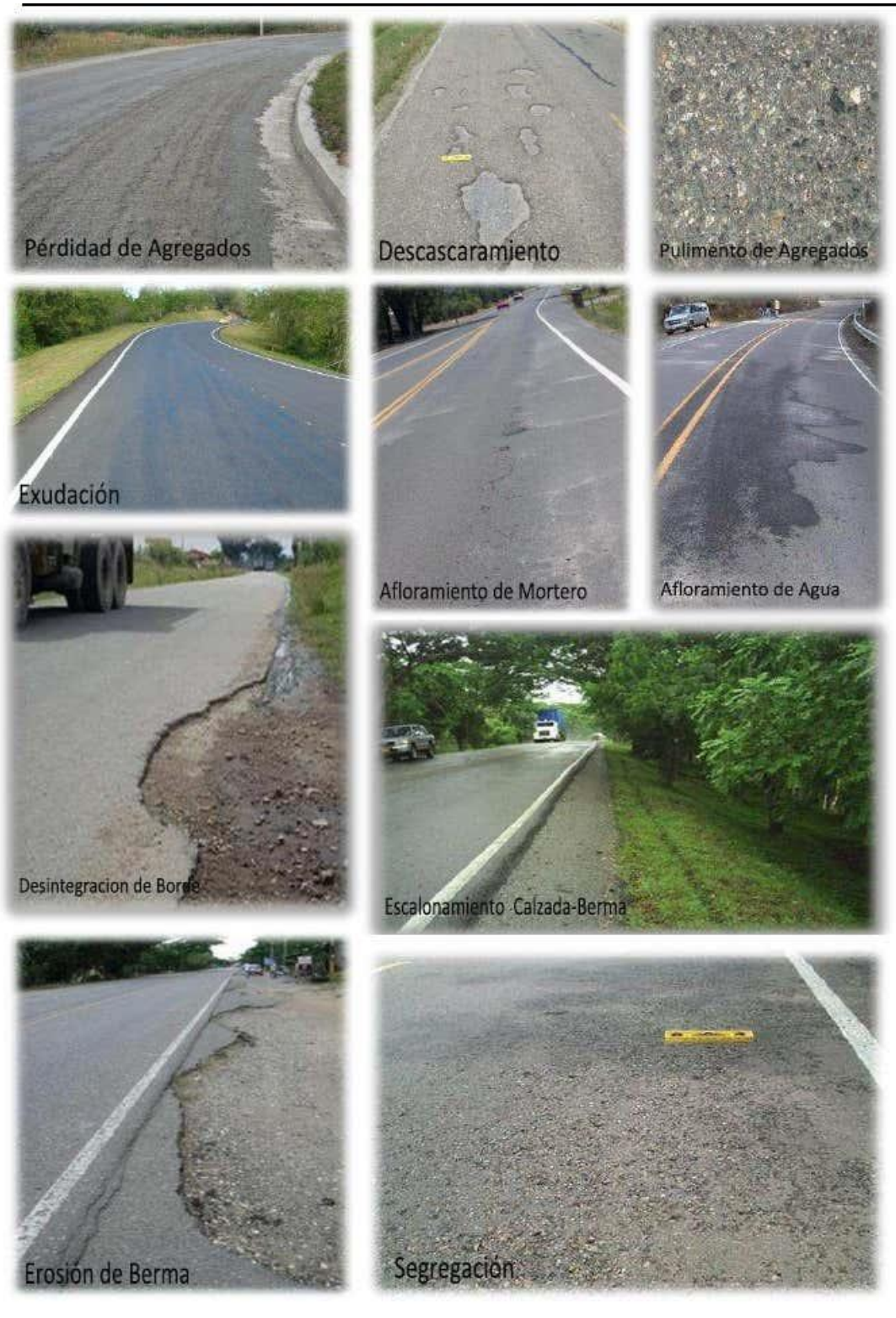
Figura N° 8: Deterioro del tipo B
