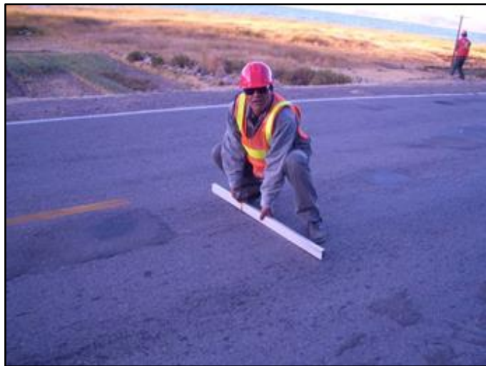
Figura N° 154: El relevamiento de fallas
