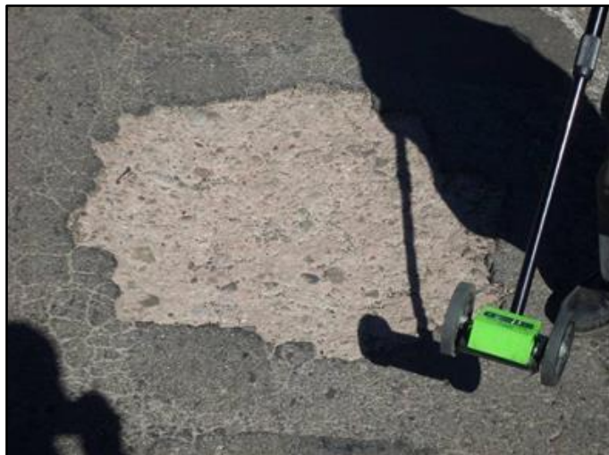
Figura N° 155: El relevamiento de fallas
