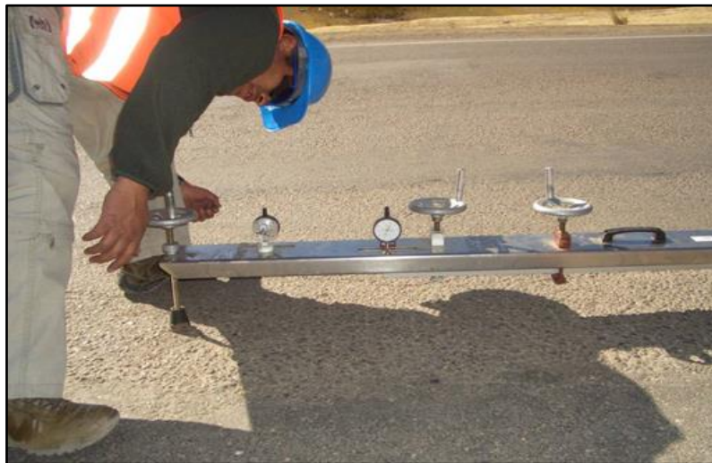
Figura N° 161: Condición Estructural del pavimento
