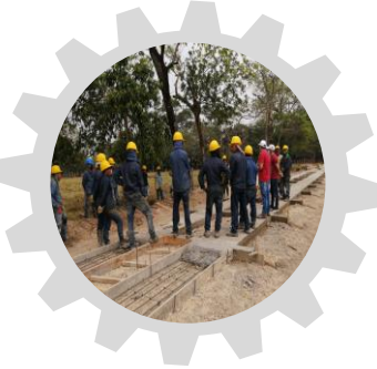
Imagen 20: Inspección física Fuente: Internet
