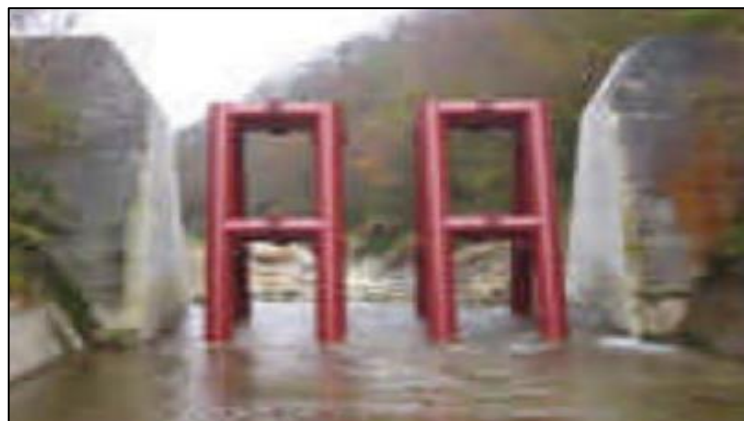
Figura N° 85. Presas permeables. Uesugi-tani river, Japón. Fuente: SABO Division, 2006.
