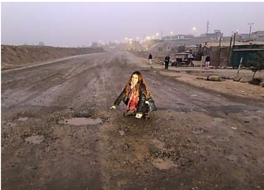
Figura N° 42: Vía de estudio- Vista de falla por baches.
