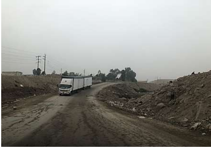
Figura N° 37: Vía de estudio- Detalle de ahuellamiento y vehículos pesados. Fuente: Elaboración propia.
