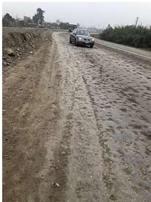
Figura N° 36: vía de estudio-Detalle de ahuellamiento.
