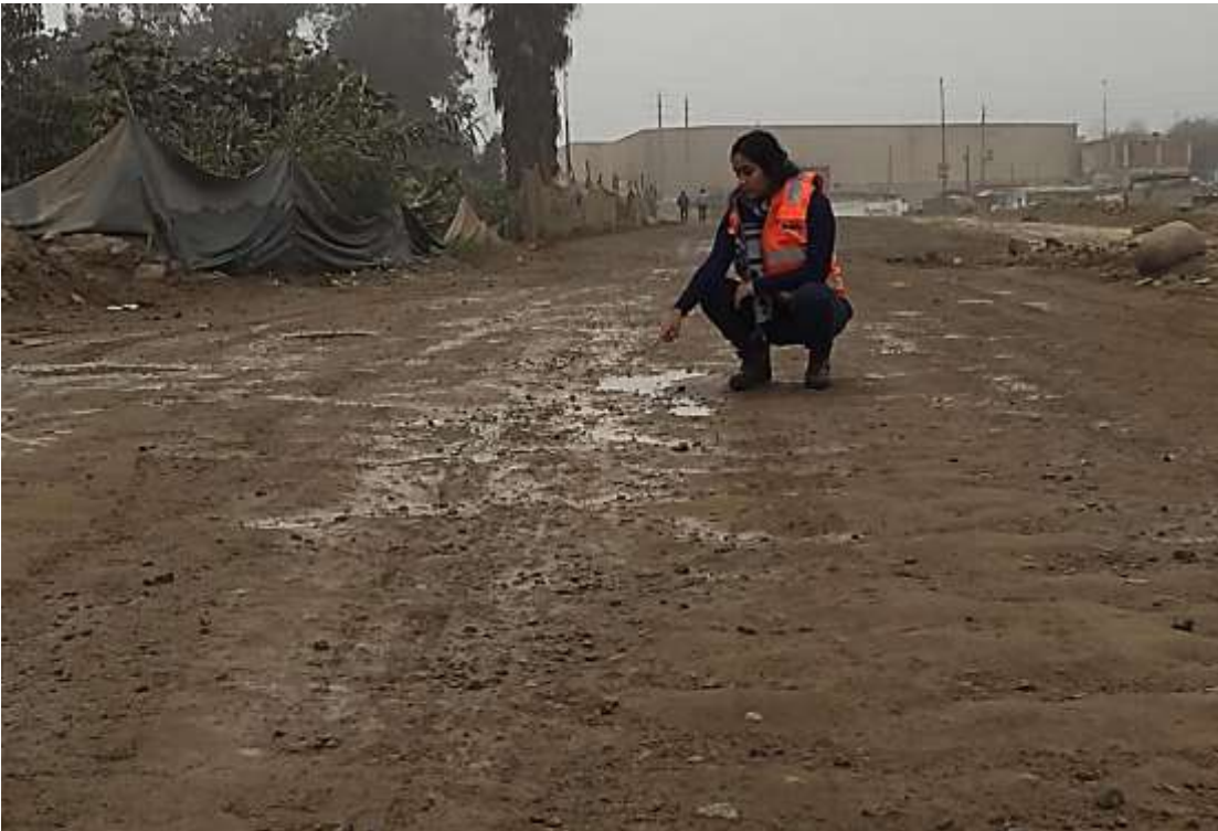
Figura N° 40: Vía de estudio – Vista de falla por infiltración.
