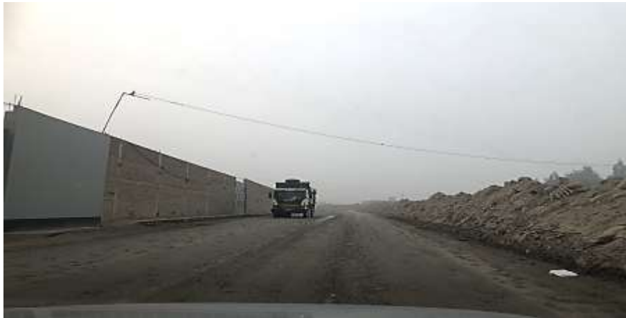
Figura N° 35: Vía de estudio – Ahuellamiento.
