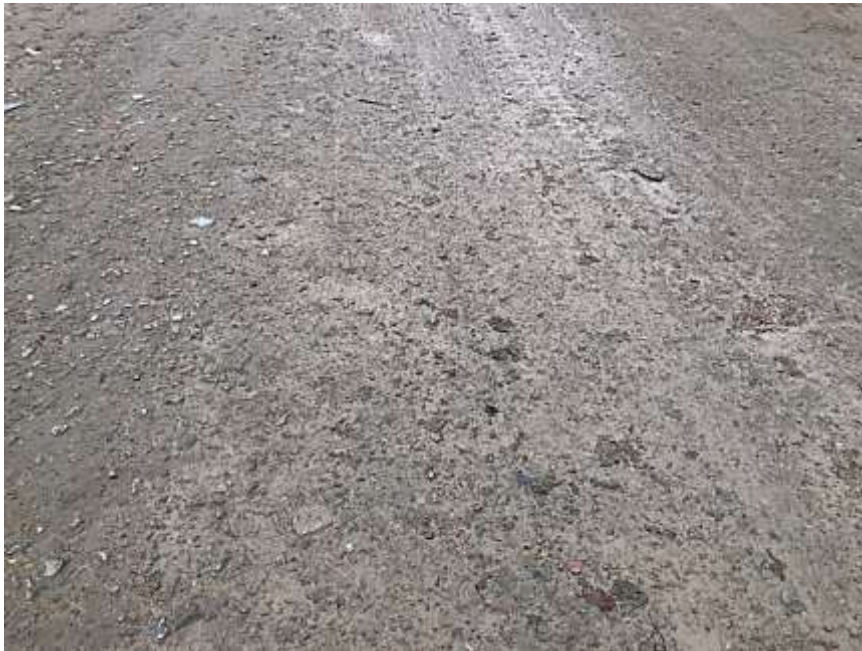
Figura N° 41: Vía de estudio- Detalle de falla por infiltración.
