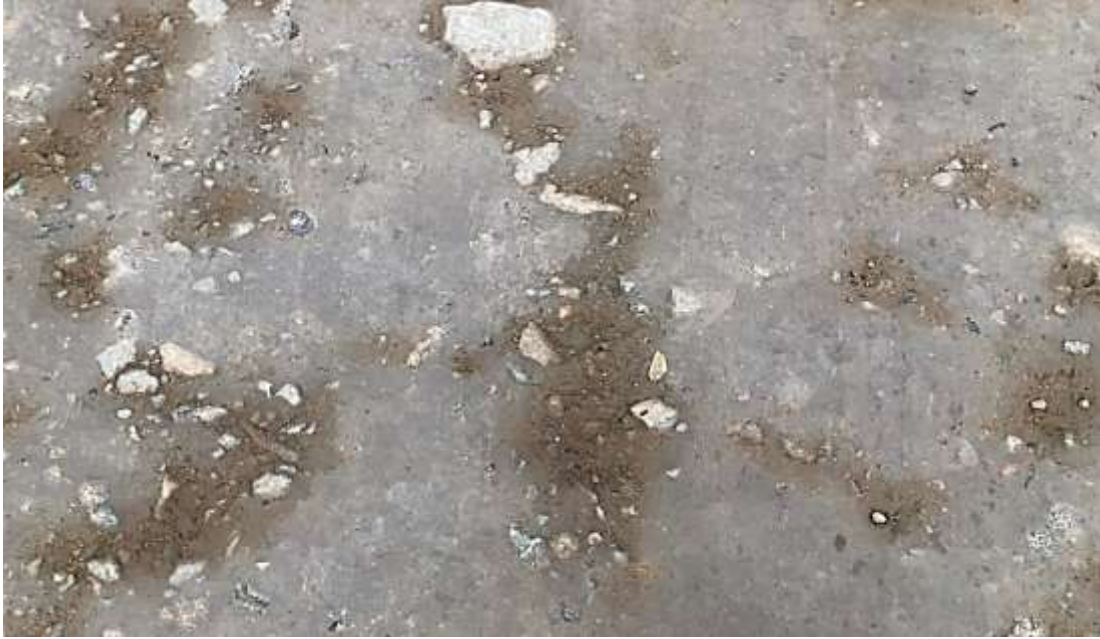
Figura N° 39: Vía de estudio- Detalle de falla por corrugación o calaminado.
