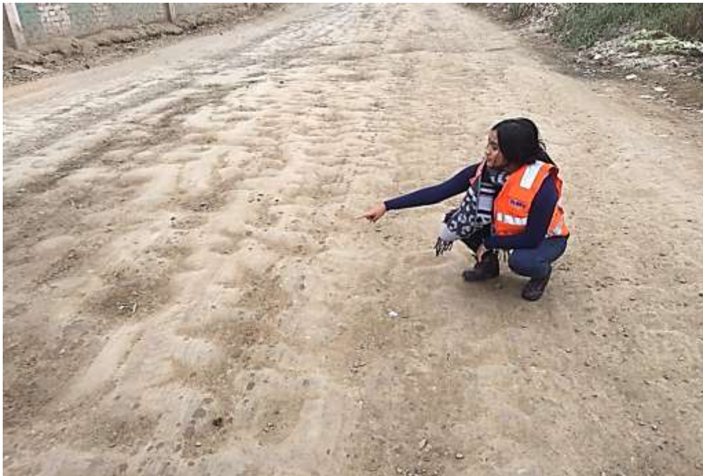
Figura N° 38: Vía de estudio – Vista de falla por corrugación o calaminado. Fuente: Elaboración propia.
