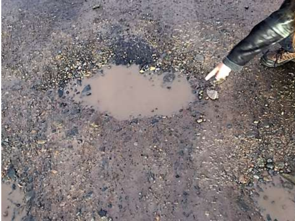
Figura N° 43: Vía de estudio- Detalle de falla por baches.
