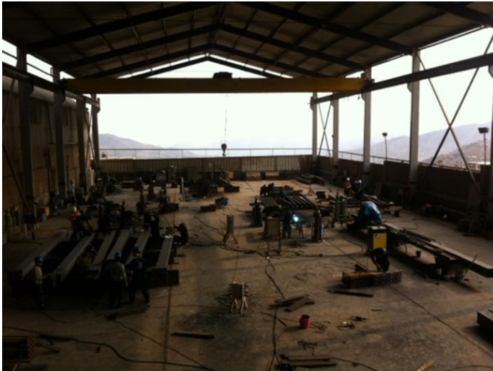
Figura N° 9: Imagen del área de soldeo de la empresa JCB Estructuras
