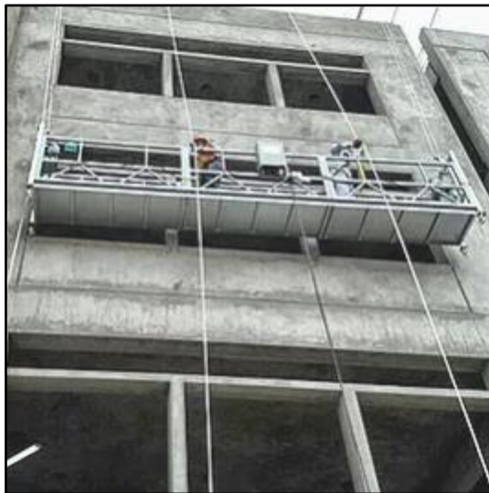
Figura 32: Andamios Colgantes Fuente: SKY
