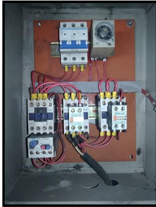
Figura 80. Tablero general eléctrico
