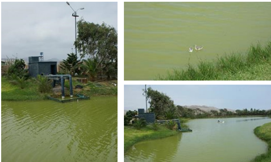
Vista N° 11: Bomba aireamiento lagunas interiores
