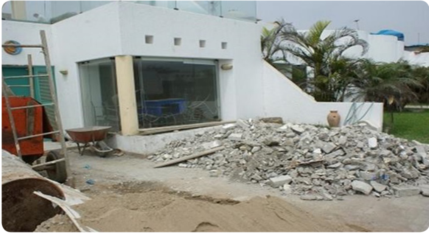
Vista N° 09: Escombros construcción típica en condominios
