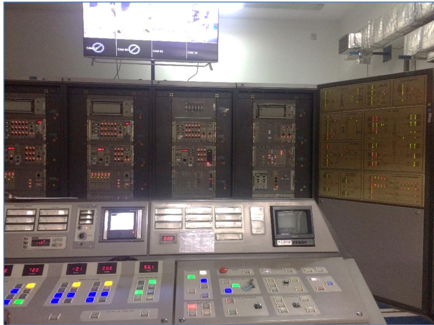
Figura 14: Instrumentación Nuclear ubicada en Sala de Control del RP-10 Fuente: IPEN
