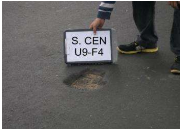
Foto 50 – Falla N° 4 – Falla Hueco
