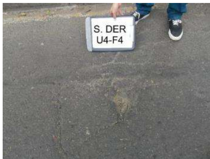
Foto 64 – Falla Nº 4 – Falla Hueco, Agrietamiento
