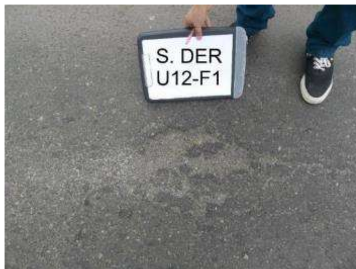
Foto 70 – Falla Nº 1 - Falla Huecos, agrietamiento
