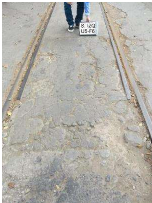
Foto 22 – Falla Nº 6 – Falla Piel de Cocodrilo, Hueco, Cruce de Vía Férrea
