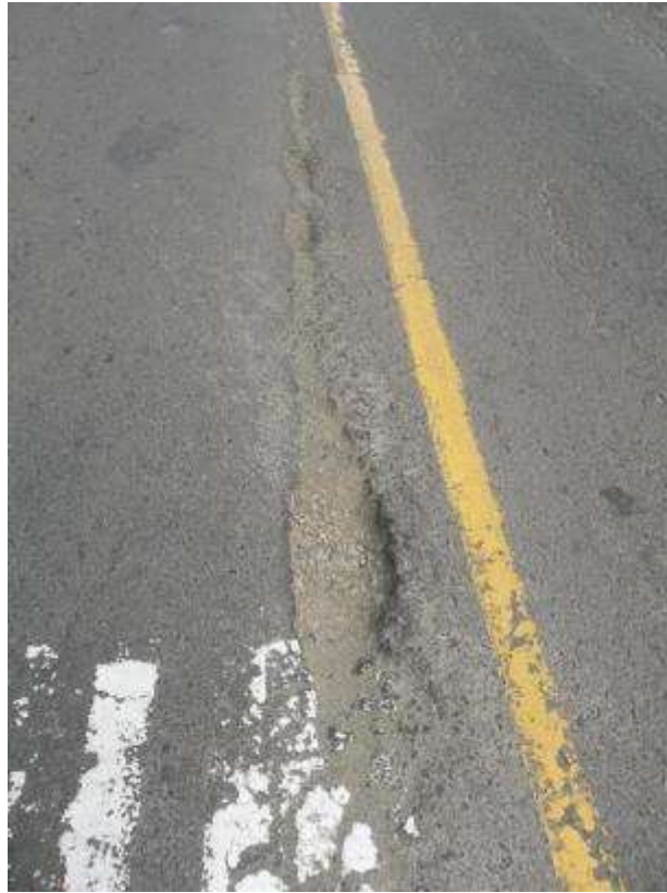
Foto 89 – Falla N°11 - Falla Huecos, Nivel de severidad moderado (13M)
