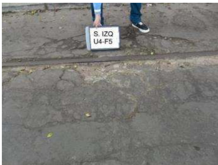
Foto 14 – Falla Nº 5 – Falla Cruce de vía férrea, hueco, piel de cocodrilo
