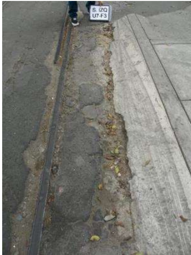
Foto 25 – Falla Nº 3 – Falla Rotura del Pavimento
