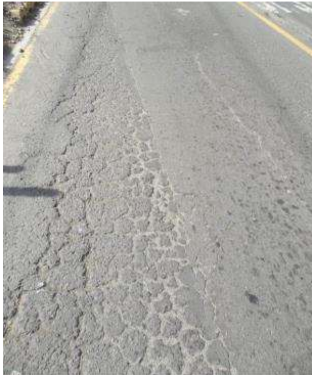
Foto 3 – Falla N°10 - Falla Piel de Cocodrilo, Nivel de severidad alto (1H)
