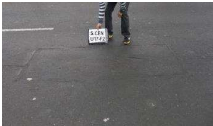
Foto 54 – Falla Nº 2 – Falla Parche, Agrietamiento
