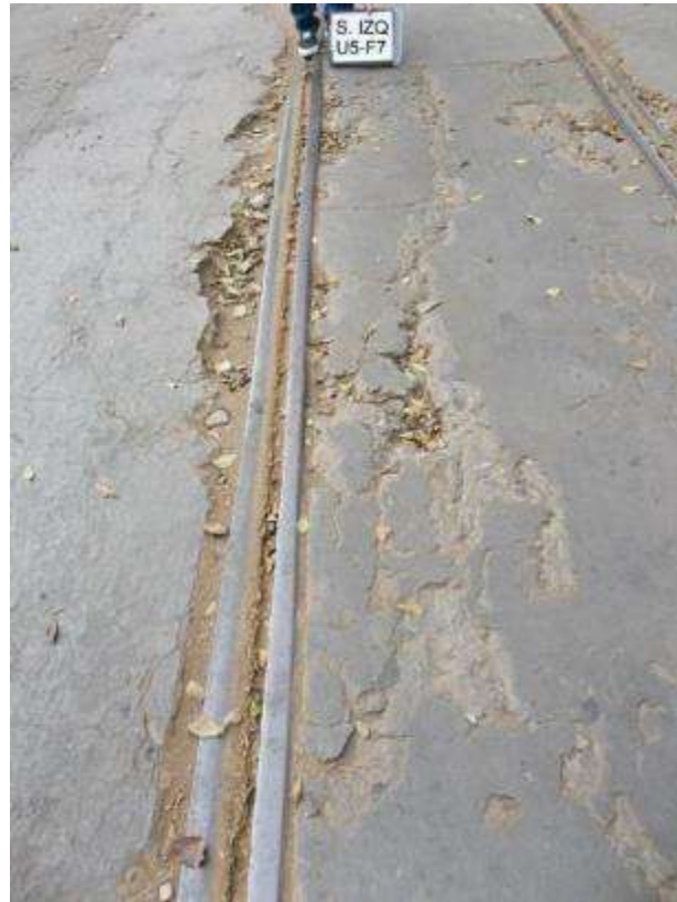
Foto 23 – Falla Nº 7 - Falla Piel de Cocodrilo, Hueco, Cruce de Vía Férrea
