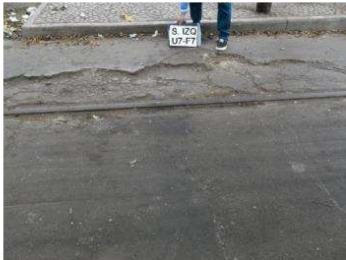
Foto 27 – Falla N° 7 – Falla Hueco, Cruce de Vía Férrea, Agrietamiento
