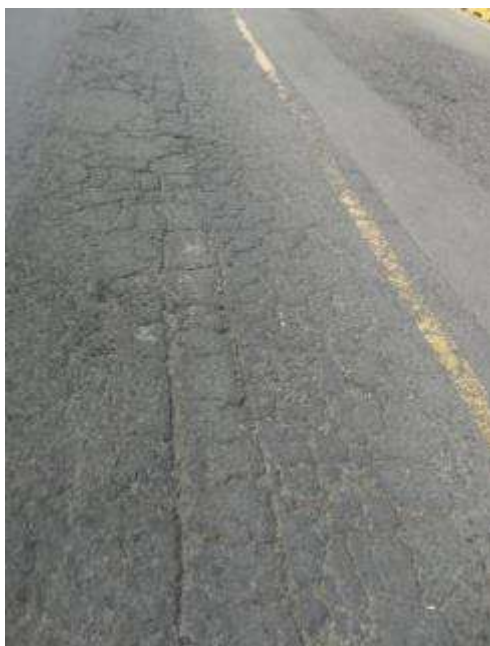
Foto 4 – Falla N° 16 – Falla Piel de Cocodrilo, Nivel de severidad alto (1H)
