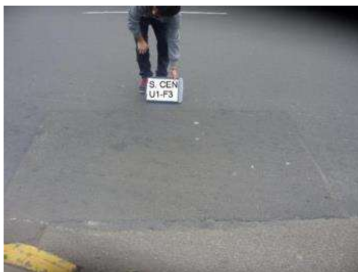
Foto 44 – Falla N° 3 – Falla Parche, agrietamiento
