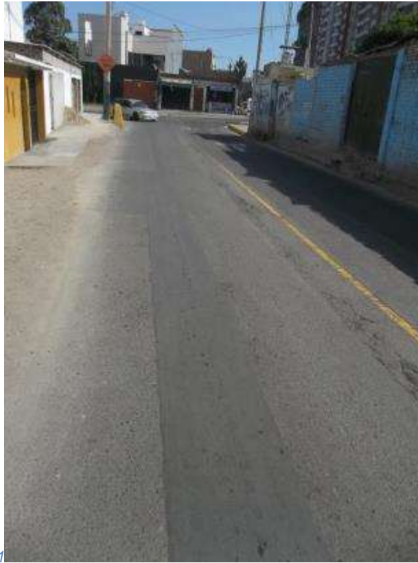
Foto 85 – Falla N°7 - Falla Parcheo, Nivel de severidad leve (11L)
