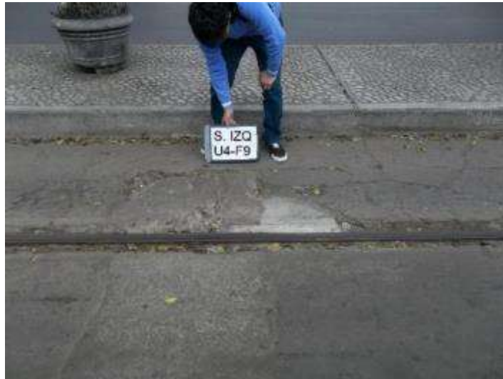
Foto 17 – Falla Nº 9 – Falla Cruce de vía férrea, agrietamiento, hueco
