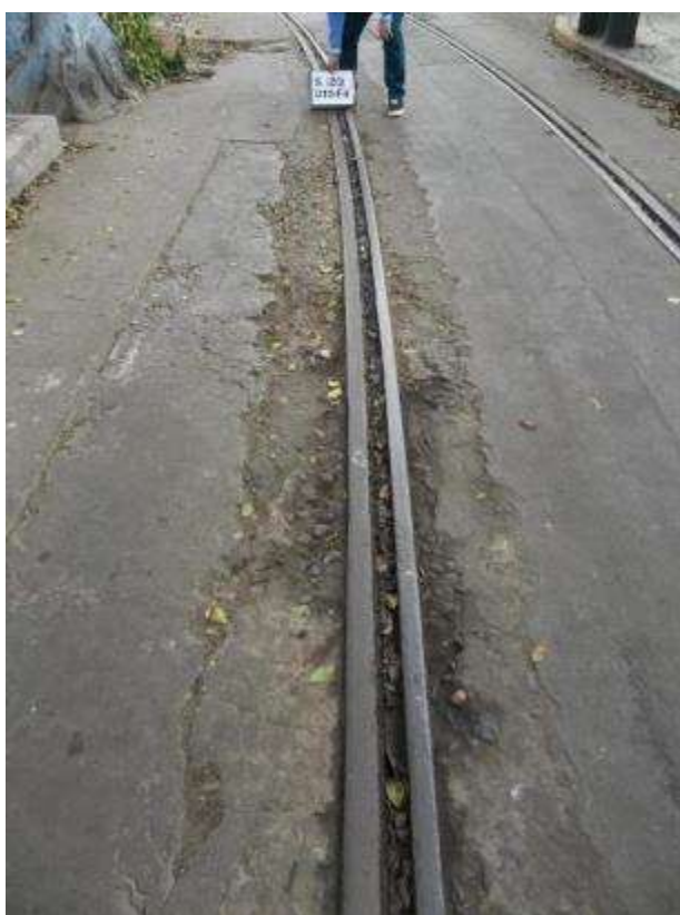
Foto 34 – Falla Nº 4 - Falla Cruce de Vía Férrea, Agrietamiento, Piel de Cocodrilo
