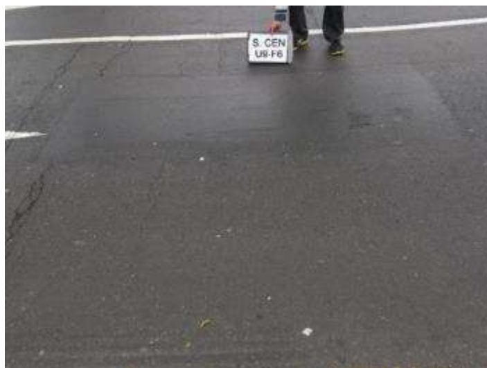
Foto 51 – Falla N° 6 – Falla Parche, Agrietamiento
