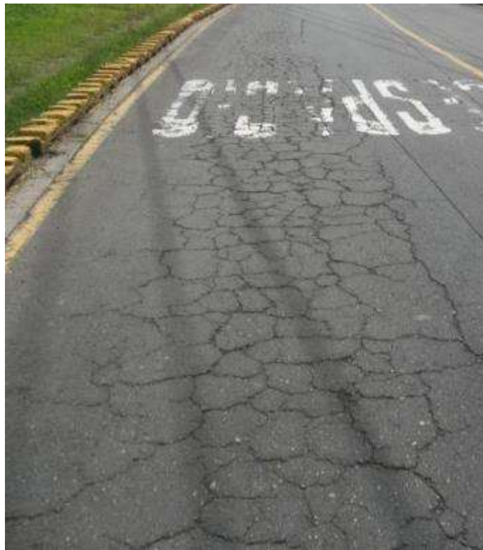
Foto 7 – Falla N°29 - Falla Piel de Cocodrilo, Nivel de severidad alto (1H)
