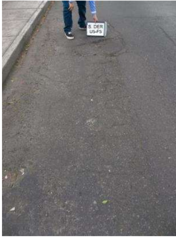
Foto 69 – Falla Nº 5 – Falla Piel de Cocodrilo, Agrietamiento en bloque
