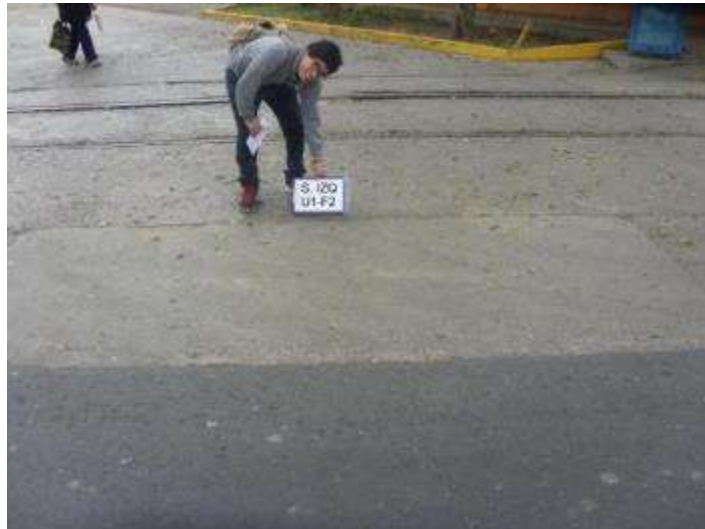
Foto 9 – Falla Nº 2 – Falla Parcheo
