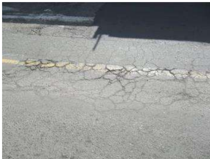
Foto 84 – Falla N°6 - Falla Piel de Cocodrilo, Nivel de severidad moderado (1M)
