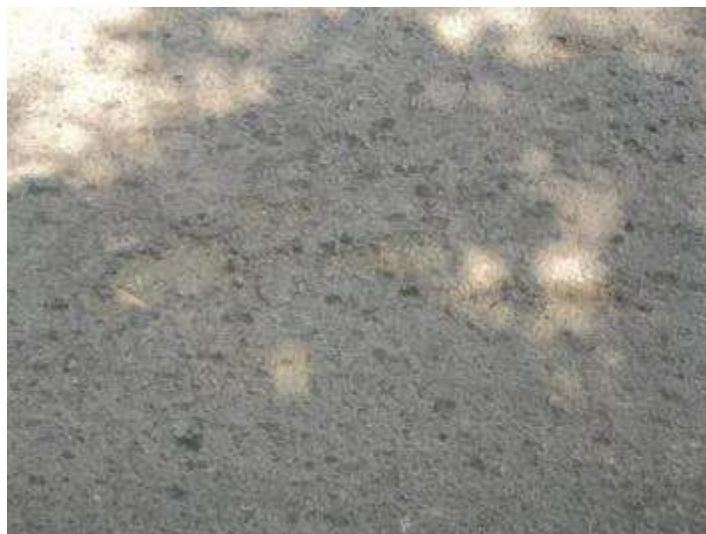
Foto 100 – Falla N°23 - Falla Huecos, Nivel de severidad leve (13L)
