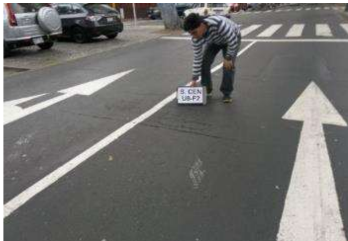
Foto 48 – Falla N° 2 – Falla Piel de Cocodrilo, Agrietamiento
