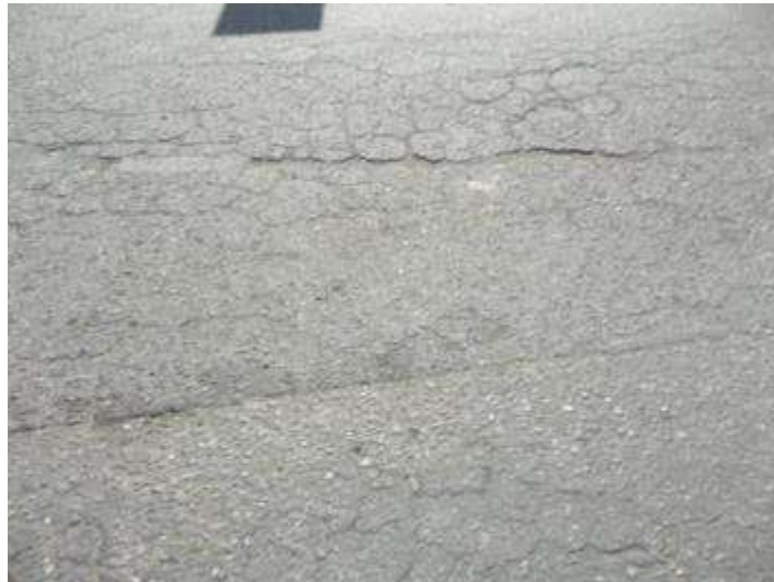
Foto 81 – Falla N°3 - Falla Piel de Cocodrilo, Nivel de severidad moderada (1M)
