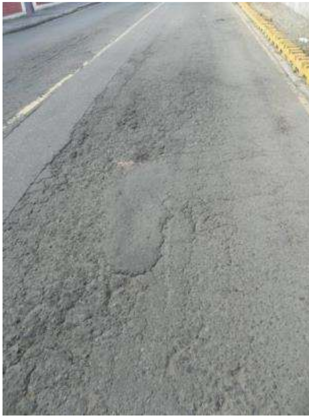
Foto 95 – Falla N°18 - Falla Piel de Cocodrilo, Nivel de severidad alta (1H)
