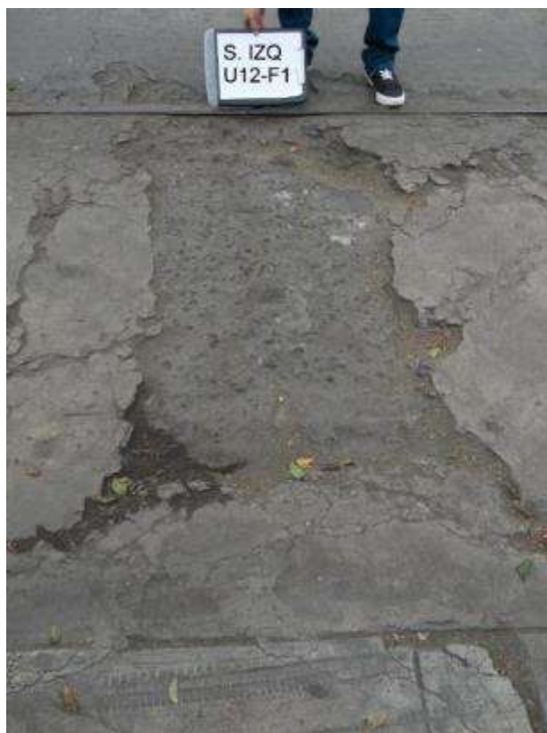
Foto 35 – Falla Nº 1 – Falla Rotura del Pavimento
