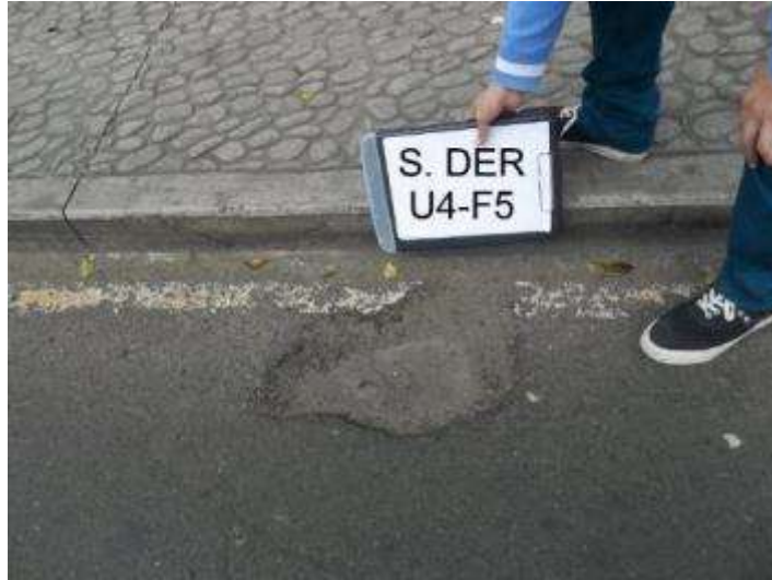
Foto 65 – Falla N° 5 – Falla Hueco
