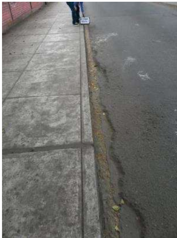
Foto 68 – Falla Nº 4 – Falla Fisura de borde
