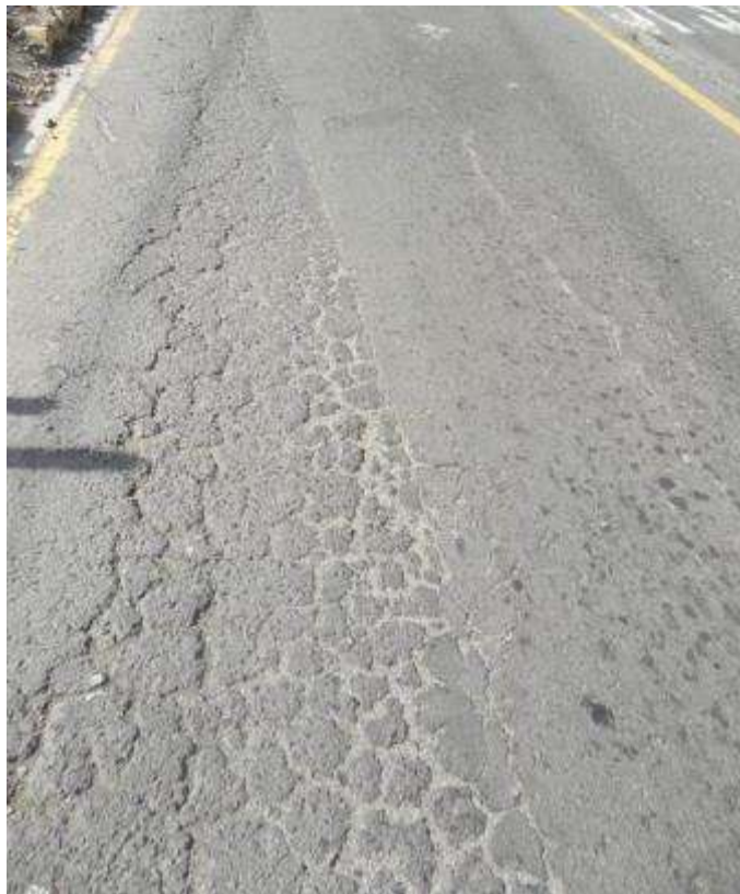
Foto 88 – Falla N°10 - Falla Piel de Cocodrilo, Nivel de severidad alta (1H)
