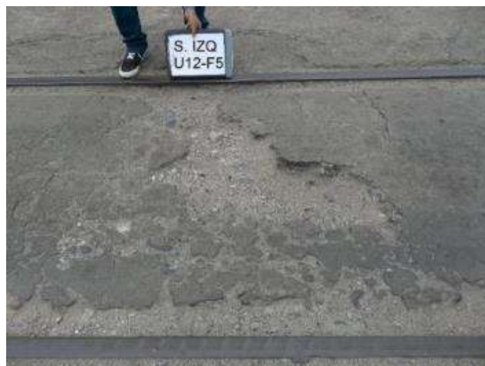
Foto 38 – Falla Nº 5 – Falla Hueco
