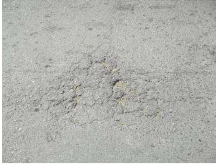
Foto 97 – Falla N°20 - Falla Piel de Cocodrilo, Nivel de severidad leve (1L)
