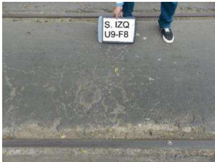
Foto 32 – Falla Nº 8 – Falla Piel de Cocodrilo, Cruce de Vía Férrea
