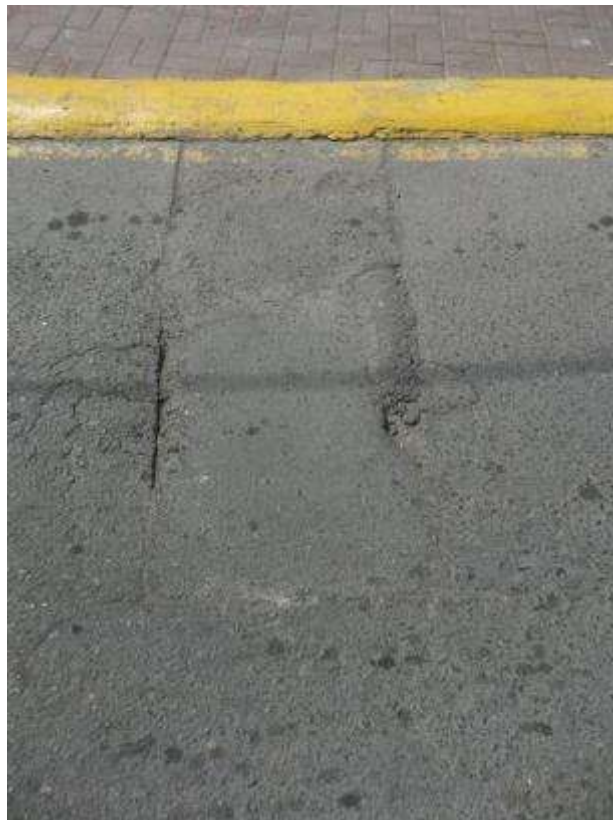
Foto 98 – Falla N°21- Falla Parcheo, Nivel de severidad leve (11L)
