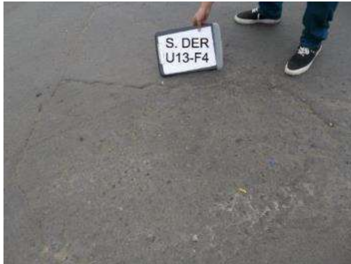
Foto 77 – Falla Nº 4 – Falla de hundimiento
