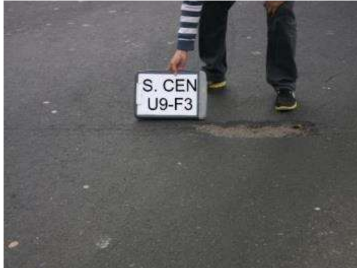
Foto 49 – Falla N° 3 – Falla Hueco, Agrietamiento
