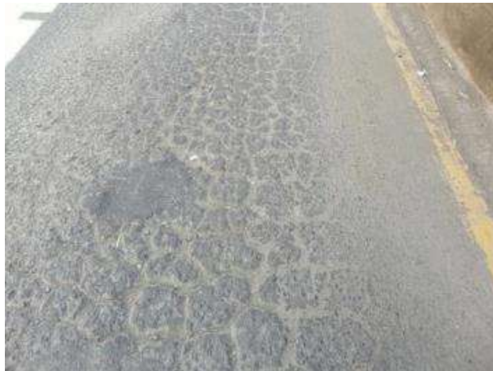
Foto 82 – Falla N°4 - Falla Piel de Cocodrilo, Nivel de severidad leve (1H)
