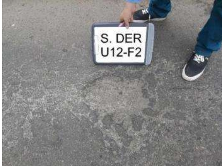
Foto 71 – Falla Nº 2 – Falla Huecos, agrietamiento
