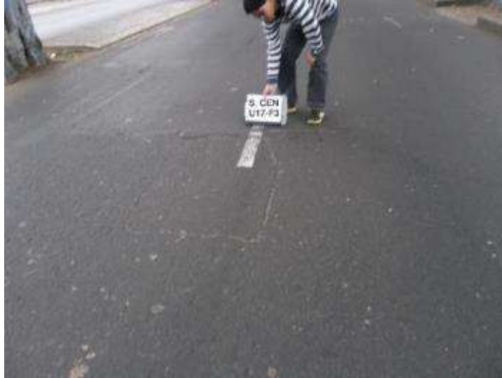
Foto 55 – Falla Nº 3 – Falla Agrietamiento en Bloque
