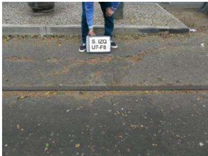
Foto 28 – Falla N° 8 – Falla Cruce de Vía Férrea, Hueco, Agrietamiento
