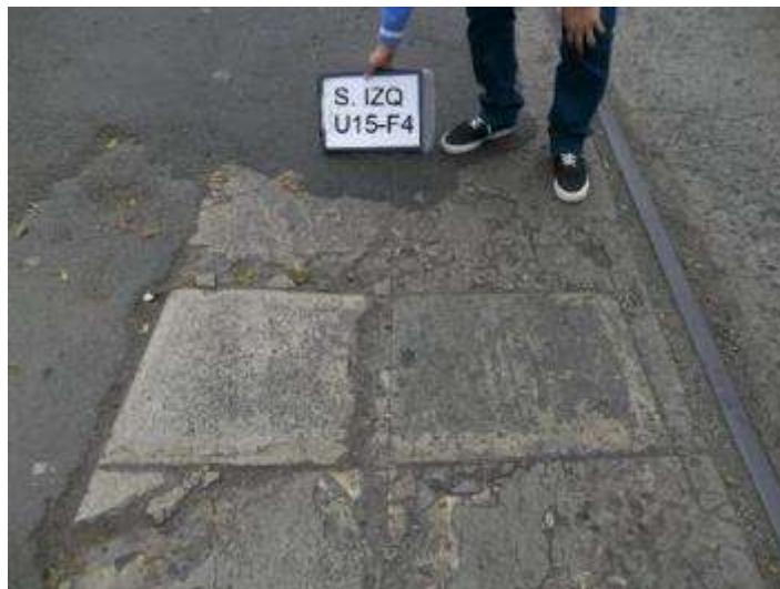
Foto 41 – Falla Nº 4 – Falla Rotura del Pavimento
