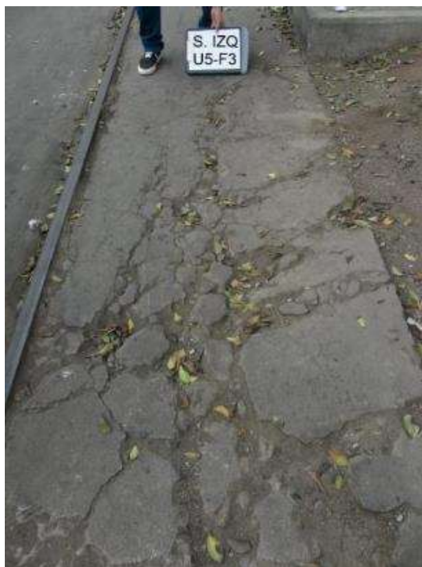
Foto 20 – Falla Nº 3 – Falla Rotura del pavimento
