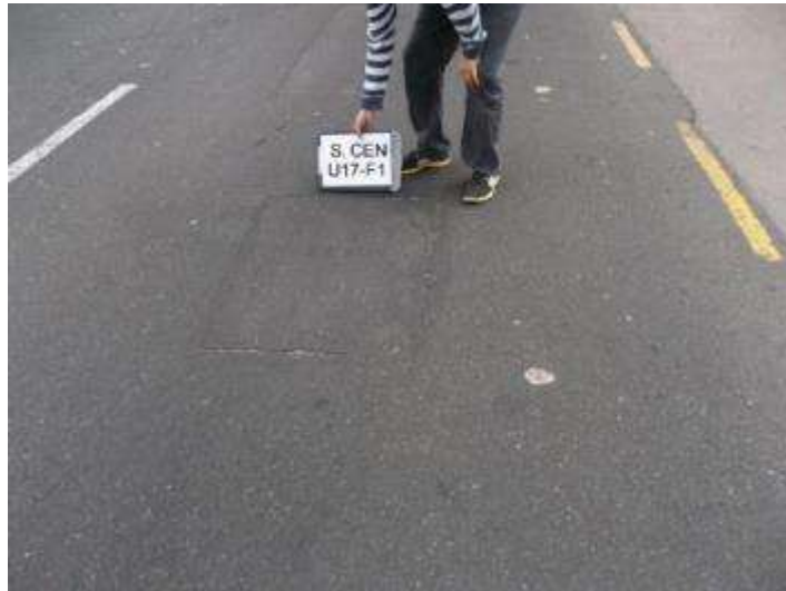
Foto 53 – Falla Nº 1 – Falla Depresión
