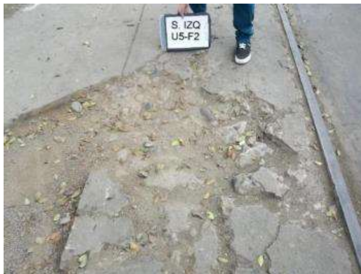
Foto 19 – Falla Nº 2 – Falla hueco.
