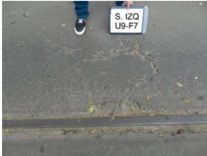
Foto 31 – Falla Nº 7 – Falla Hueco, Cruce de Vía Férrea, Agrietamiento
