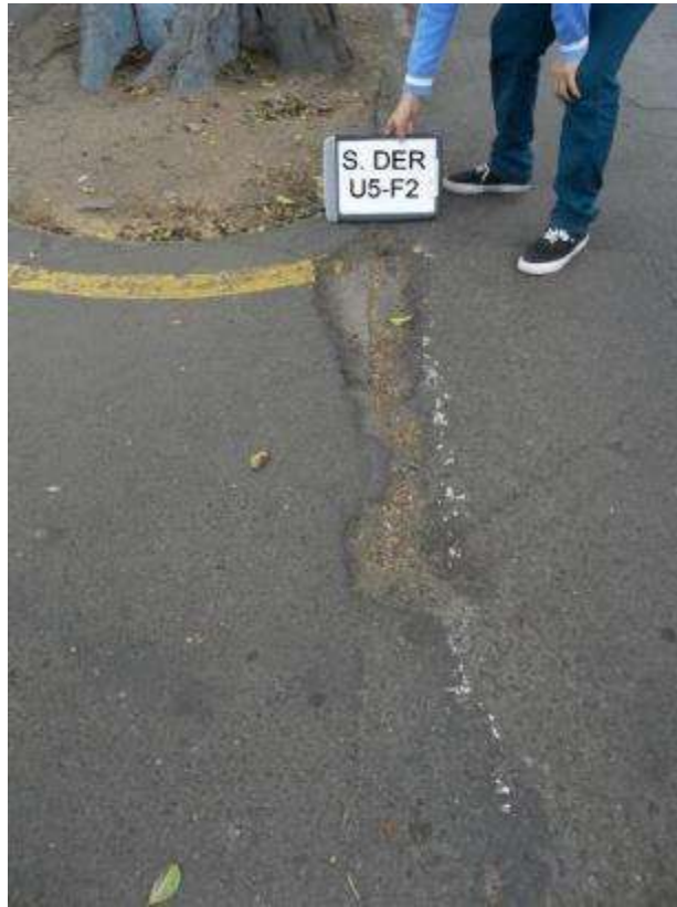
Foto 67 – Falla Nº 2 – Falla Hueco, agrietamiento
