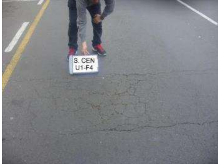
Foto 45 – Falla N° 4 – Falla Piel de Cocodrilo
