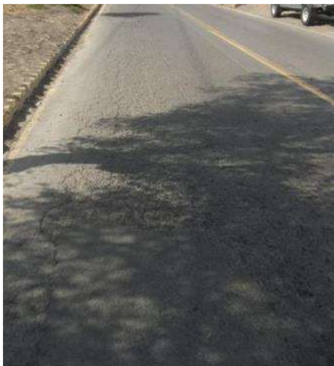
Foto 2 – Falla N°8 – Falla de Piel de Cocodrilo, Nivel de severidad alto (1H)
