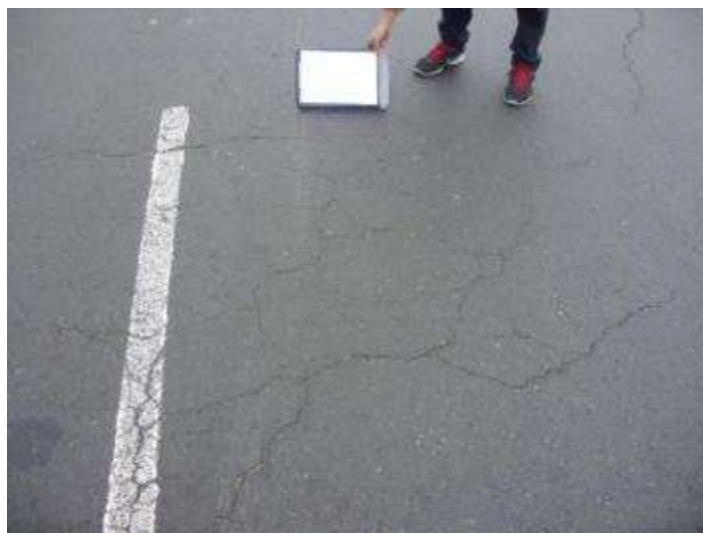
Foto 43 – Falla N° 1 – Falla agrietamiento en bloque
