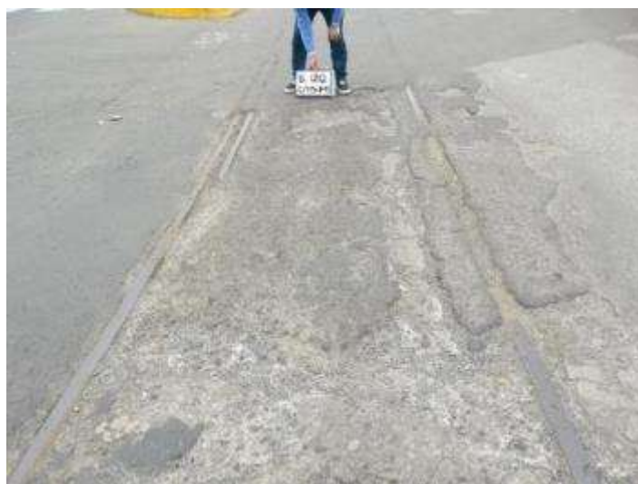
Foto 42 – Falla Nº 5 – Falla Rotura del Pavimento
