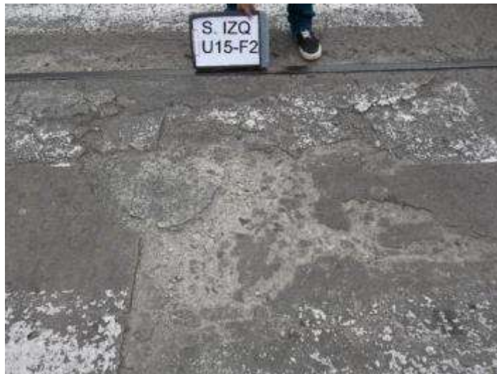
Foto 40 – Falla Nº 2 – Falla Rotura del Pavimento
