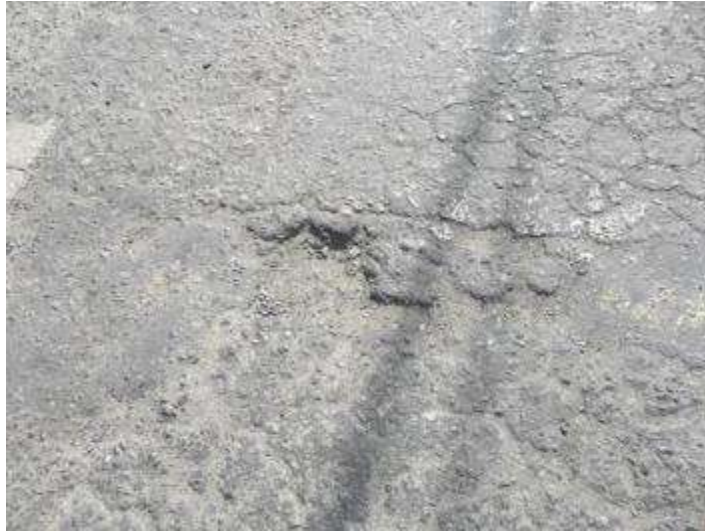
Foto 79 – Falla N°1 - Falla Huecos y Piel de Cocodrilo, Nivel de severidad leve (13L)
