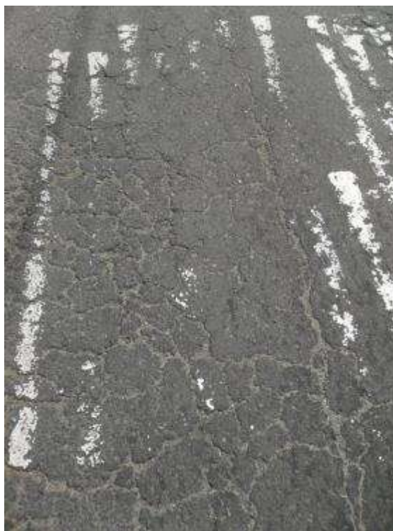
Foto 6 – Falla N°25 – Falla Piel de Cocodrilo, Nivel de severidad medio (1M)
