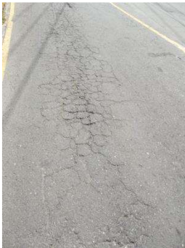
Foto 104 – Falla N°28 - Falla Piel de Cocodrilo, Nivel de severidad moderada (1M)
