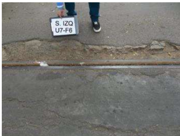
Foto 26 – Falla Nº 6 – Falla Cruce de Vía Férrea
