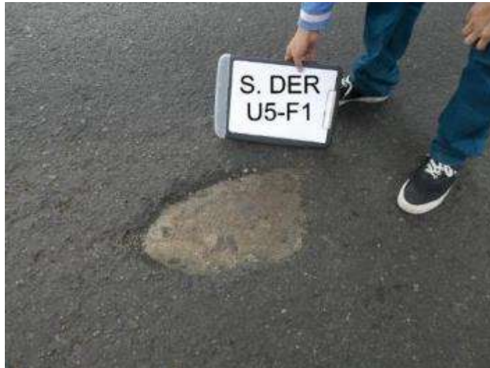
Foto 66 – Falla N° 1 - Falla Hueco
