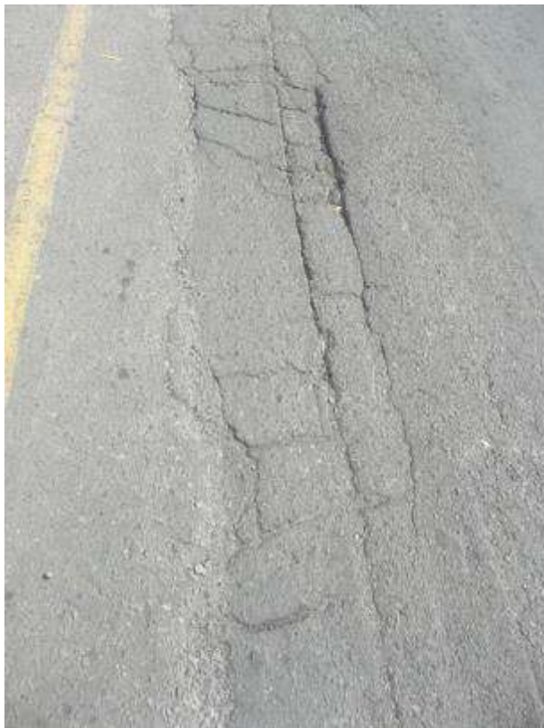
Foto 96 – Falla N°19 - Falla Agrietamiento en bloque, Nivel de severidad moderada (3M)
