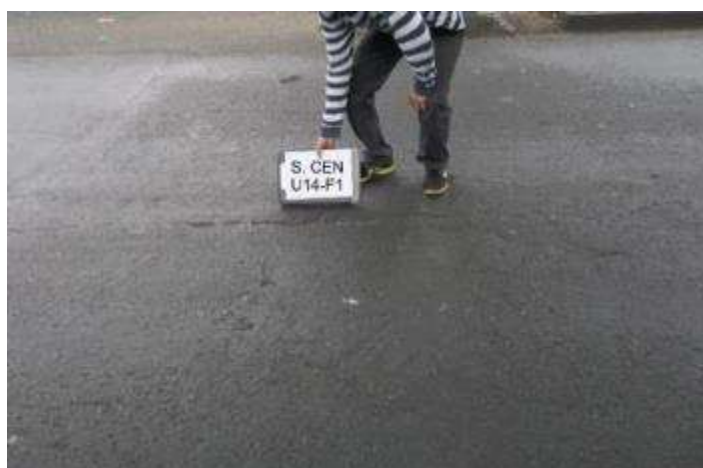
Foto 52 – Falla N° 1 - Agrietamiento
