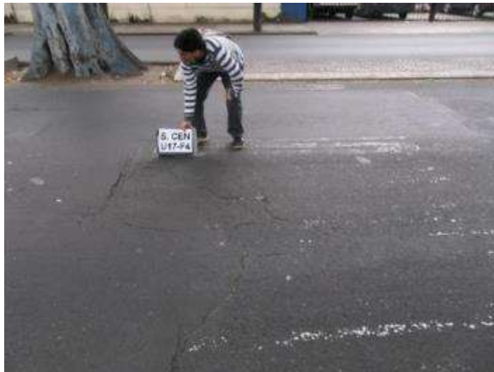
Foto 56 – Falla Nº 4 – Falla Parche, Agrietamiento
