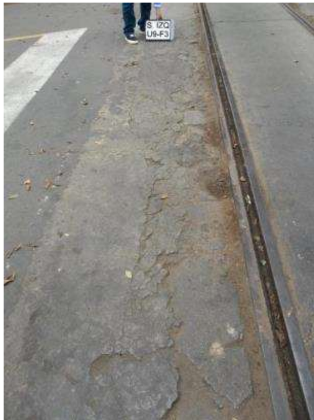
Foto 30 – Falla Nº 3 – Falla Cruce de Vía Férrea, Agrietamiento
