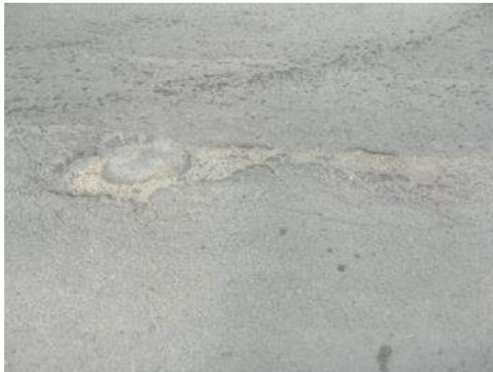
Foto 92 – Falla N°15 - Falla Huecos, Nivel de severidad leve (13L)
