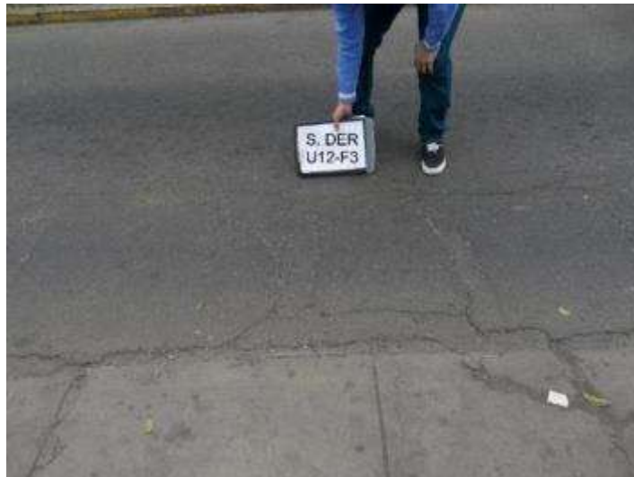
Foto 72 – Falla Nº 3 – Falla Agrietamiento en bloque
