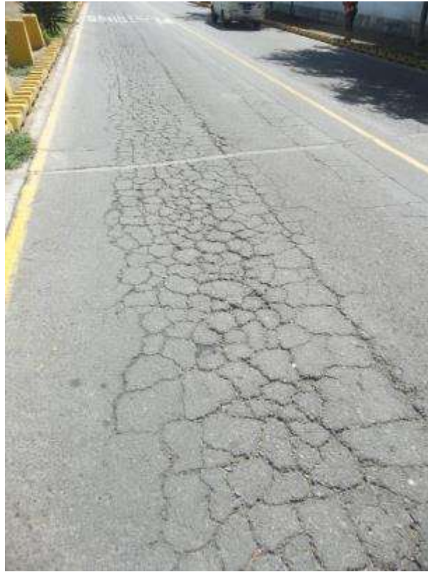
Foto 99 – Falla N°22 - Falla Piel de Cocodrilo, Nivel de severidad alta (1H)
