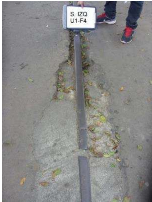
Foto 11 – Falla Nº 4 – Falla Cruce de Vía Férrea
