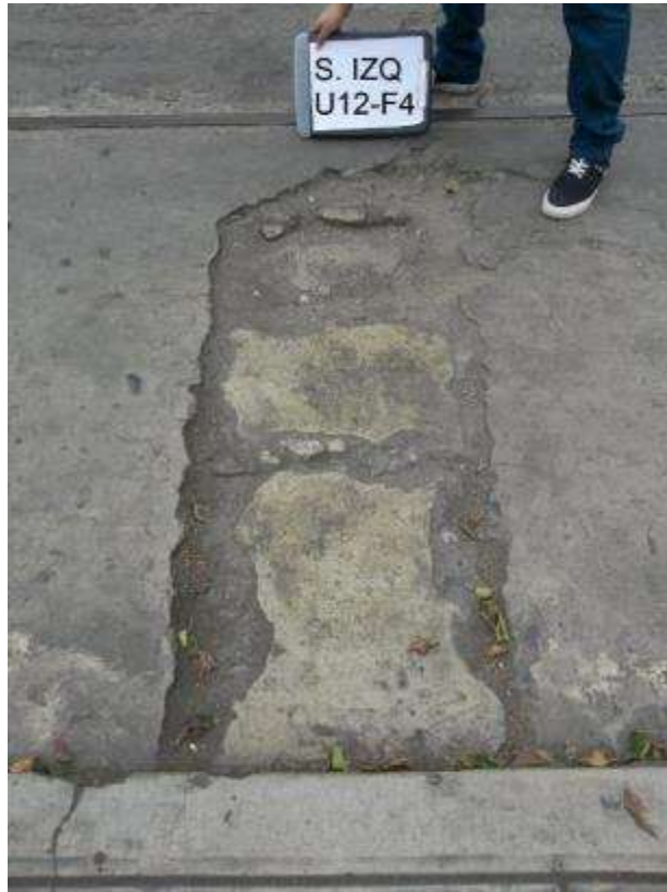
Foto 37 – Falla Nº 4 – Falla Parcheo, Hueco
