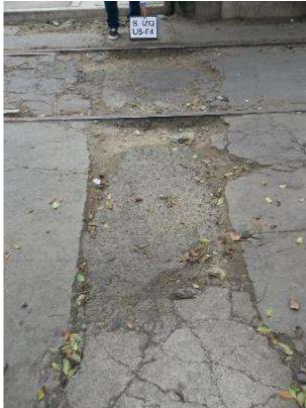
Foto 21 – Falla Nº 4 – Falla Rotura de pavimento
