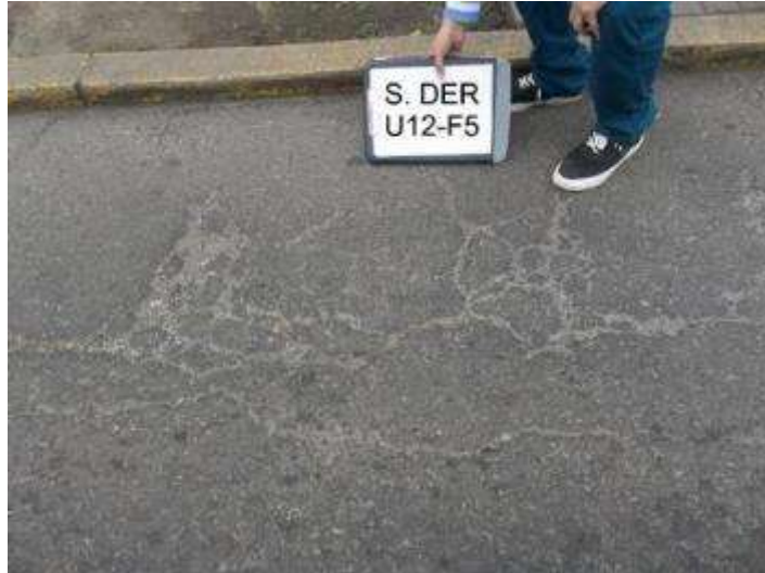
Foto 73 – Falla Nº 5 – Falla Grietas en bloque
