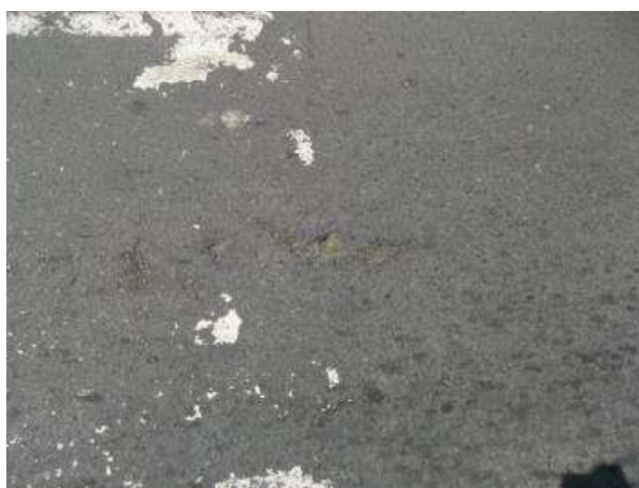
Foto 106 – Falla N°30 - Falla Huecos, Nivel de severidad leve (13L)
