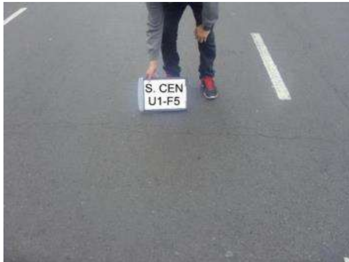
Foto 46 – Falla N° 5 – Falla Agrietamiento transversal
