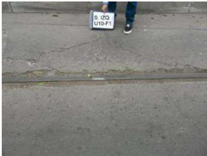
Foto 33 – Falla Nº 1 – Falla Hinchamiento, Agrietamiento, Piel de Cocodrilo
