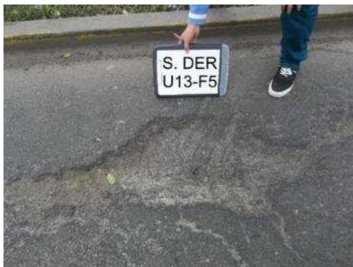
Foto 78 – Falla Nº 5 – Falla de Hueco, agrietamiento
