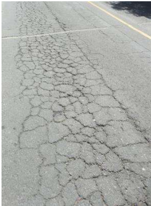
Foto 5 – Falla N°22 – Falla Piel de Cocodrilo, Nivel de severidad alto (1H)
