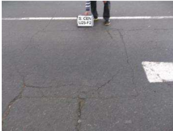
Foto 59 – Falla Nº 2 – Falla Agrietamiento en Bloque
