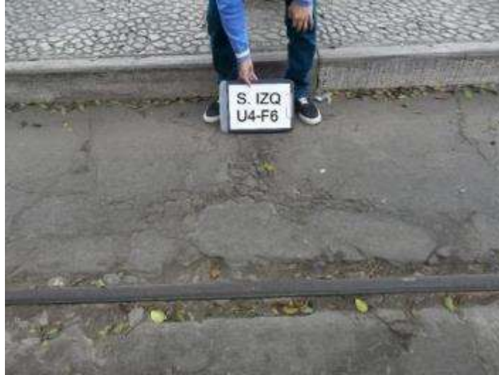
Foto 15 – Falla N° 6 – Falla Hueco y agrietamiento
