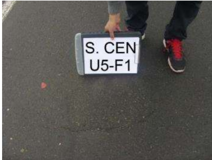
Foto 47 – Falla N° 1 – Falla Hueco
