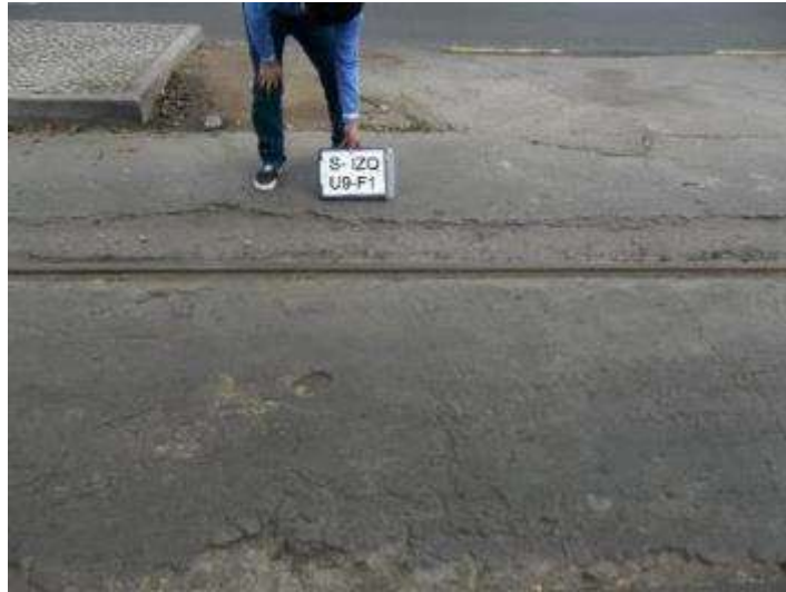
Foto 29 – Falla Nº 1 – Falla Cruce de Vía Férrea, Agrietamiento, Piel de Cocodrilo
