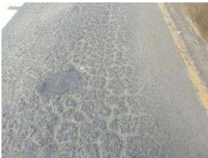
Foto 1 - Falla N°4 – Falla Piel de Cocodrilo, Nivel de severidad alto (1H)
