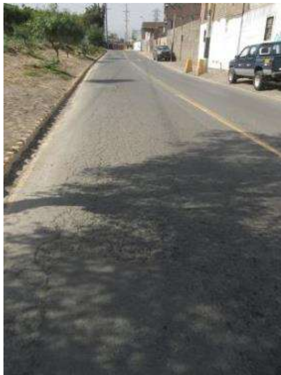
Foto 86 – Falla N°8 - Falla Piel de Cocodrilo, Nivel de severidad alto (1H)
