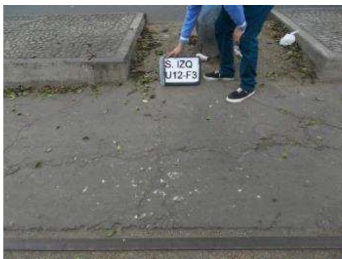
Foto 36 – Falla Nº 3 – Falla Hinchamiento, Agrietamiento
