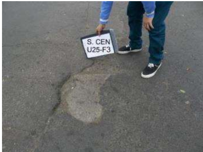
Foto 60 – Falla Nº 3 – Falla Hueco
