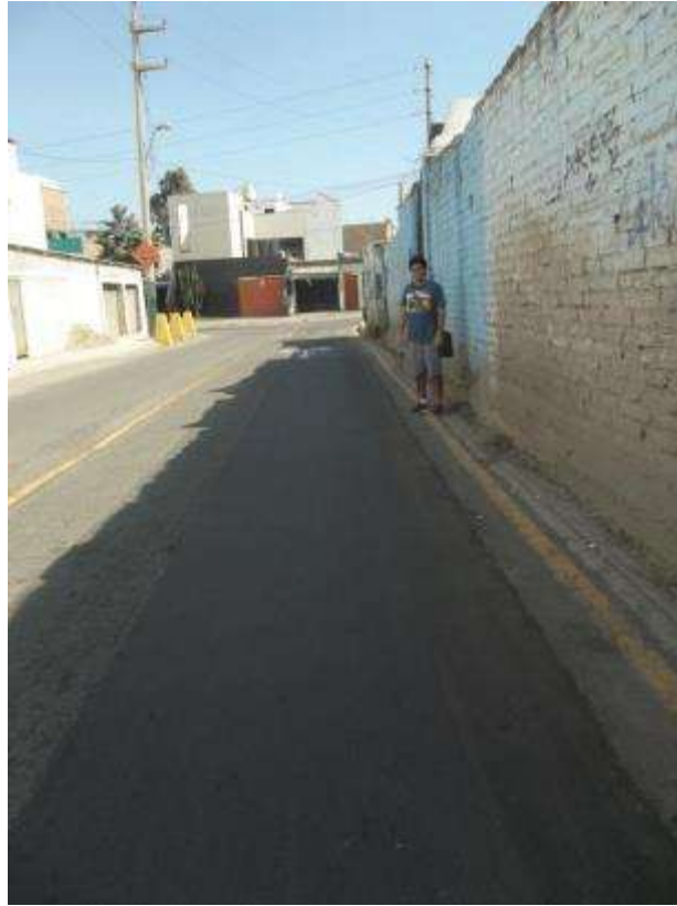
Foto 83 – Falla N°5 - Falla Parcheo, Nivel de severidad leve (11L)
