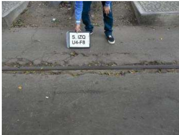
Foto 16 – Falla N° 8 – Falla Abultamiento, Rotura del pavimento, cruce de vía férrea
