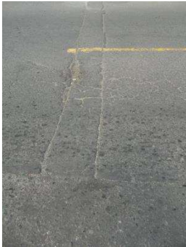
Foto 90 – Falla N°13 - Falla Parcheo, Nivel de severidad moderada (11M)
