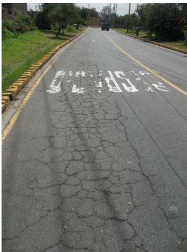
Foto 105 – Falla N°29 - Falla Piel de Cocodrilo, Nivel de severidad alta (1H)
