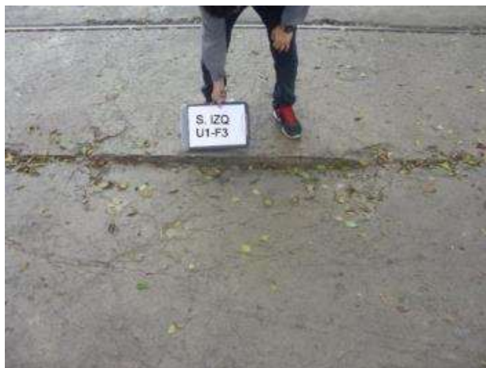
Foto 10 – Falla Nº 3 – Falla Junta y Huecos
