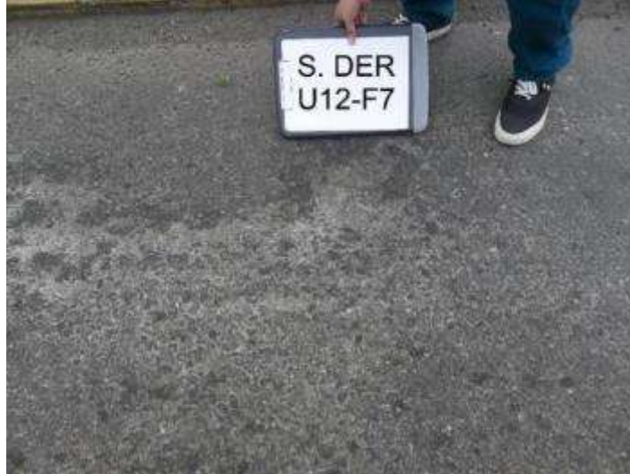
Foto 75 – Falla N° 7 – Falla de hueco
