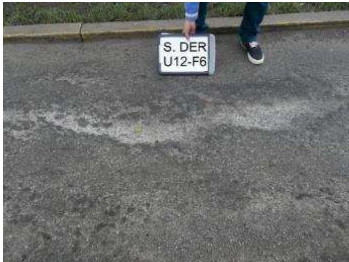
Foto 74 – Falla Nº 6 – Falla Hueco, Agrietamiento.
