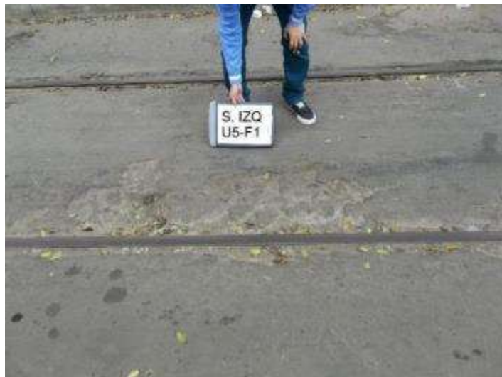
Foto 18 – Falla Nº 1 – Falla Piel de Cocodrilo, cruce de vía férrea
