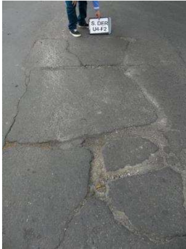
Foto 63 – Falla Nº 2 – Falla Agrietamiento en Bloque. Hueco
