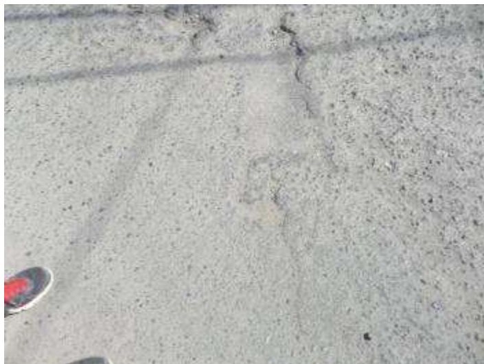
Foto 80 – Falla N°2 - Falla Huecos, Nivel de severidad leve (13L)
