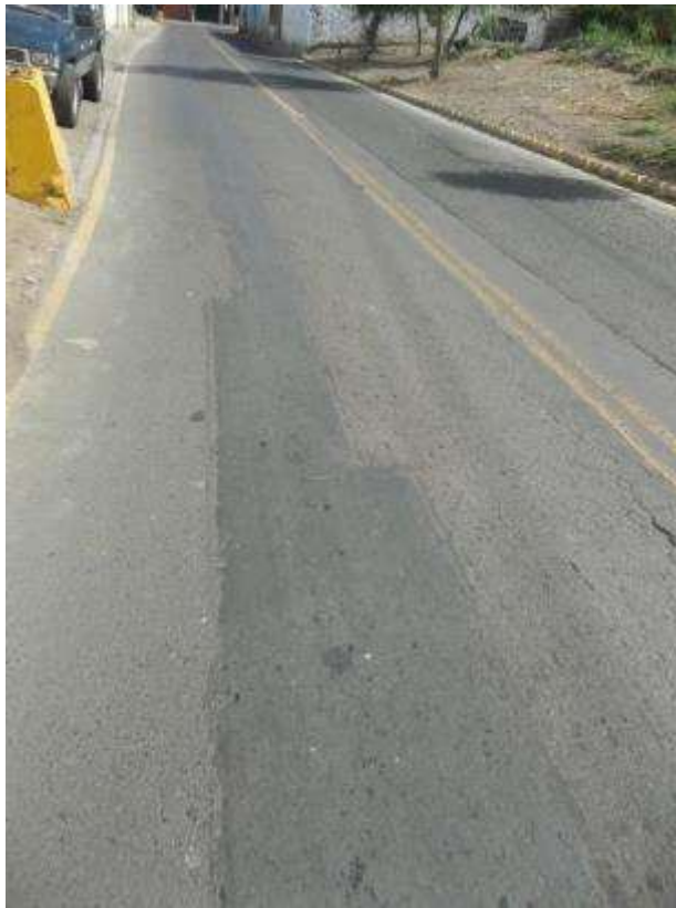
Foto 87 – Falla N°9 - Falla Parcheo, Nivel de severidad leve (11L)
