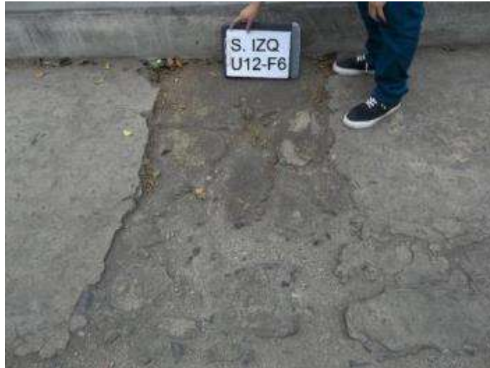
Foto 39 – Falla Nº 6 – Falla Rotura del Pavimento
