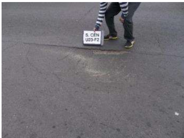
Foto 58 – Falla Nº 2 – Falla Depresión
