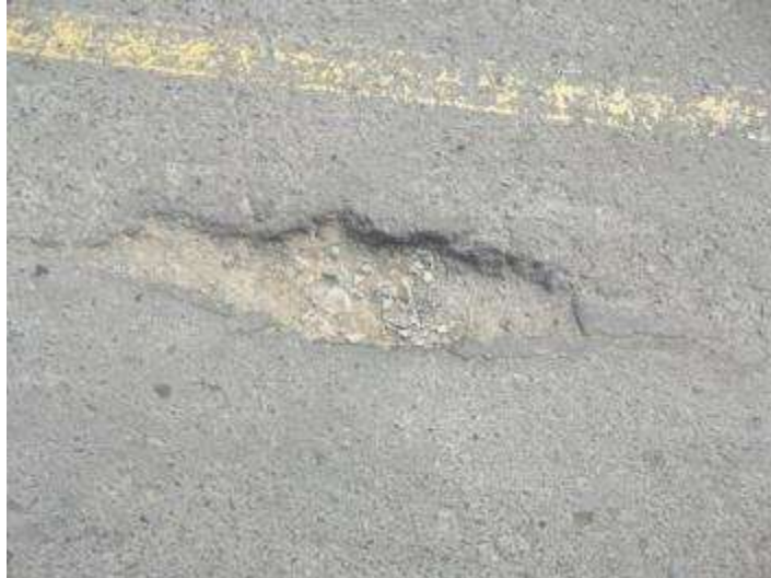
Foto 91 – Falla N°14 - Falla Huecos, Nivel de severidad leve (13L)
