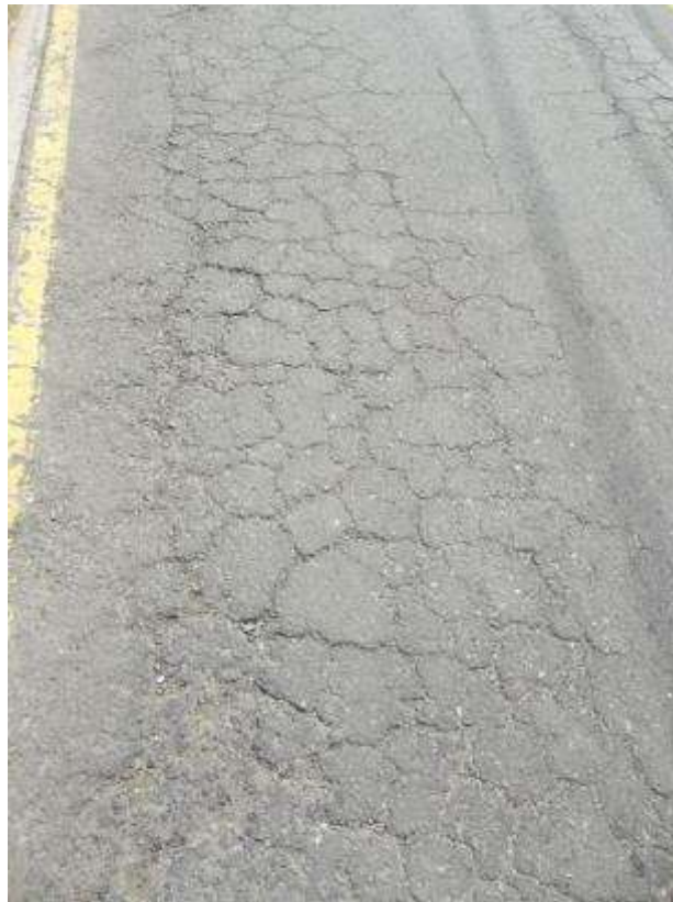
Foto 103 – Falla N°27 - Falla Piel de Cocodrilo, Nivel de severidad moderada (1M)
