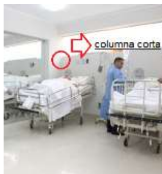
Figura N° 9: Problema de columna corta
