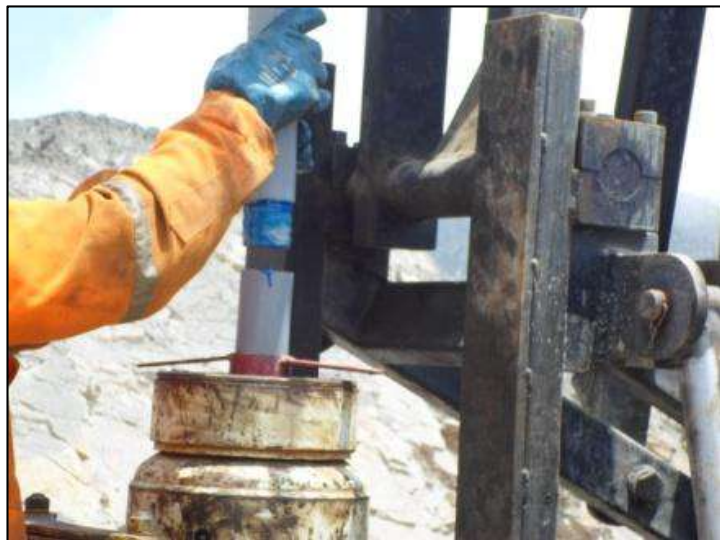
Foto N° 2.4.3: Instalación de tubo de PVC en zona perforada. Fuente: Geo Master - Informe de Limpieza y Drenaje de Piezómetros para Estudio Hidrogeológico de la U.E.A. Cristina, 2014.
