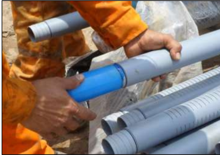
Foto N° 2.4.2: Habilitación de tubo de PVC. Fuente: Geo Master - Informe de Limpieza y Drenaje de Piezómetros para Estudio Hidrogeológico de la U.E.A. Cristina 2014.
