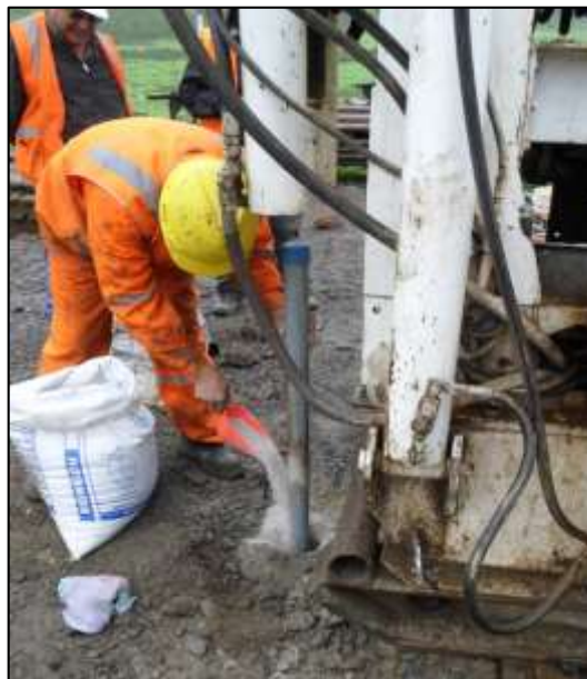
Foto N° 2.4.5: Colocación de lechada de cemento con bentonita. Fuente: Geo Master - Informe de Limpieza y Drenaje de Piezómetros para Estudio Hidrogeológico de la U.E.A. Cristina, 2014.
