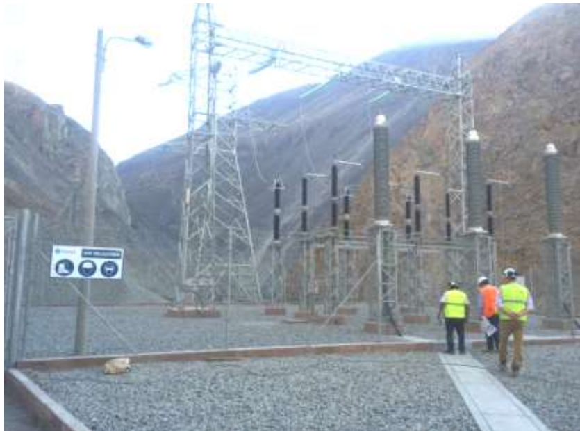
Foto N°12: Torres y Líneas de Transmisión – Proyecto Cheves
