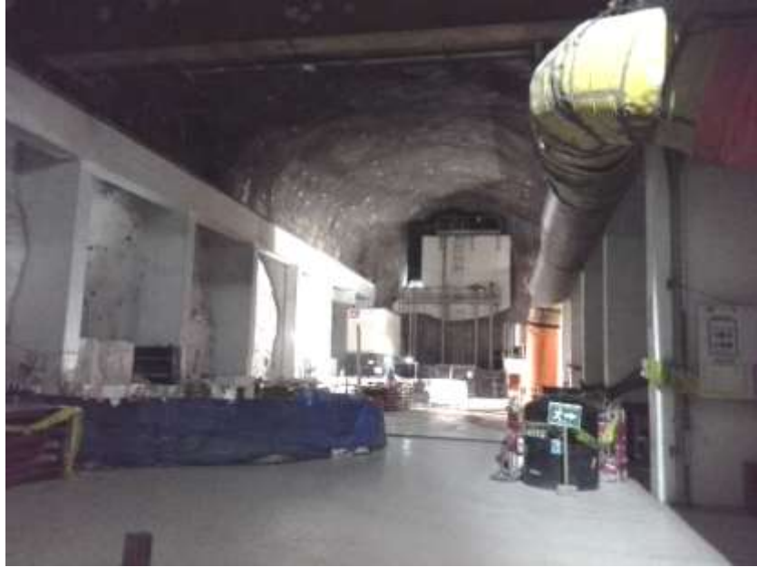
Foto N°10: Casa de Máquinas – Proyecto Cheves
