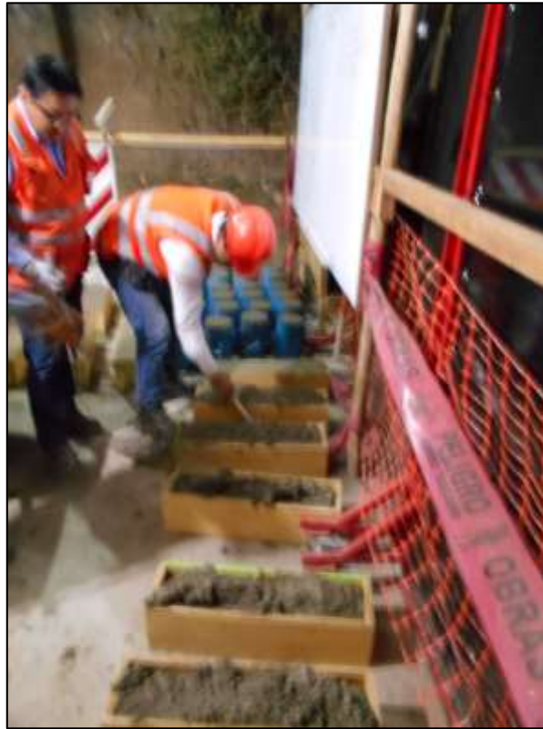
Hincado a la mezcla con varilla de acero dentro de las Vigas
