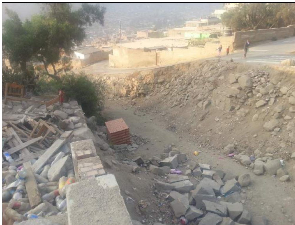
Foto 37. Falta de muro de contención
