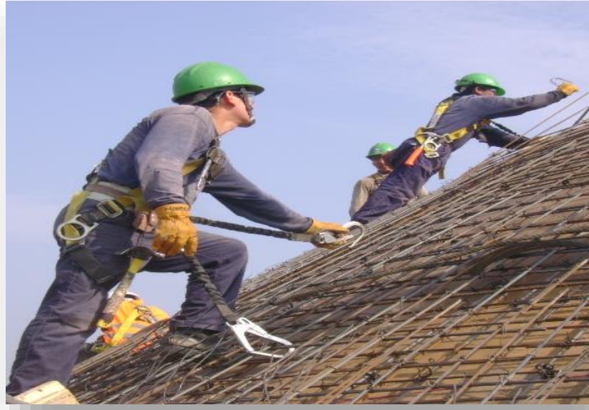
Foto 22: Trabajador laborando con arnés con doble engancho.
