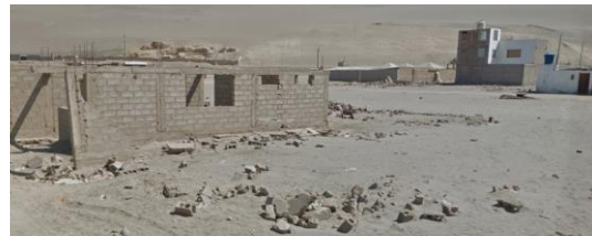
Fotografía 1 Casa afectada por el
