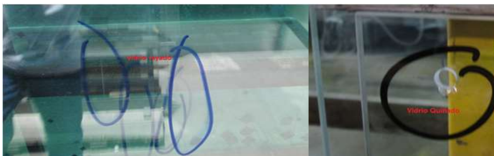
Figura 21: Imagen de vidrios defectuosos
