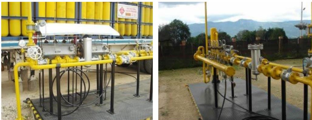
Figura 27. Estación de descompresión de GNC
