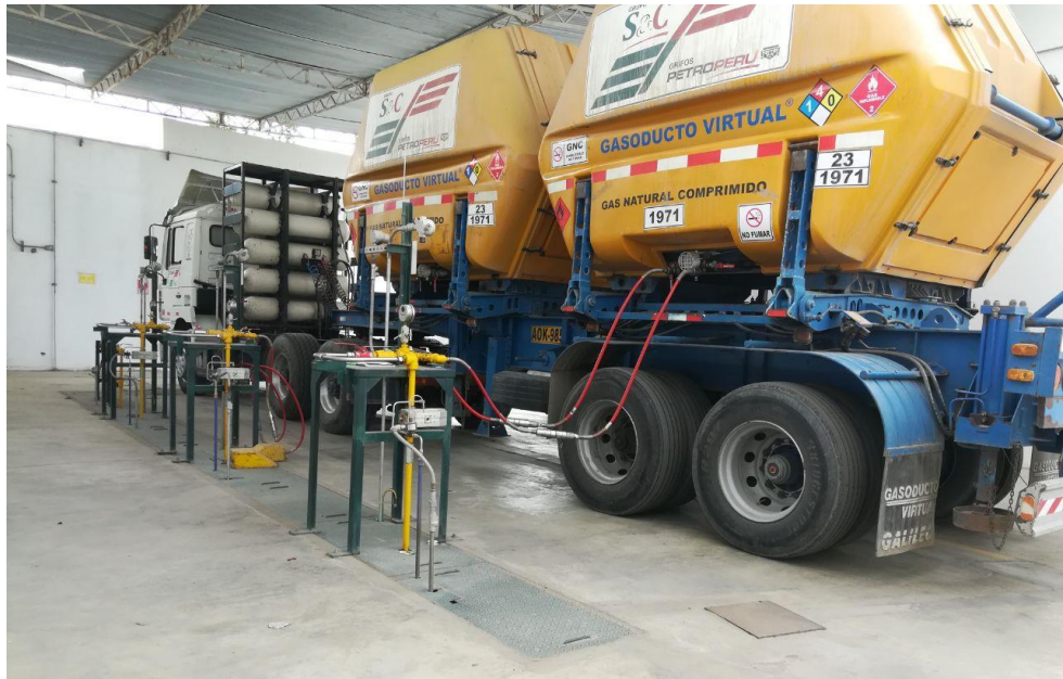
Figura 21. Torres de llenado de GNC en módulos MAT
