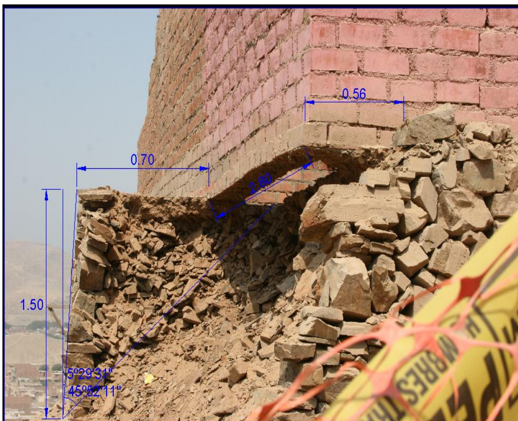
6.1: Dimensiones de la zona de colapso.
