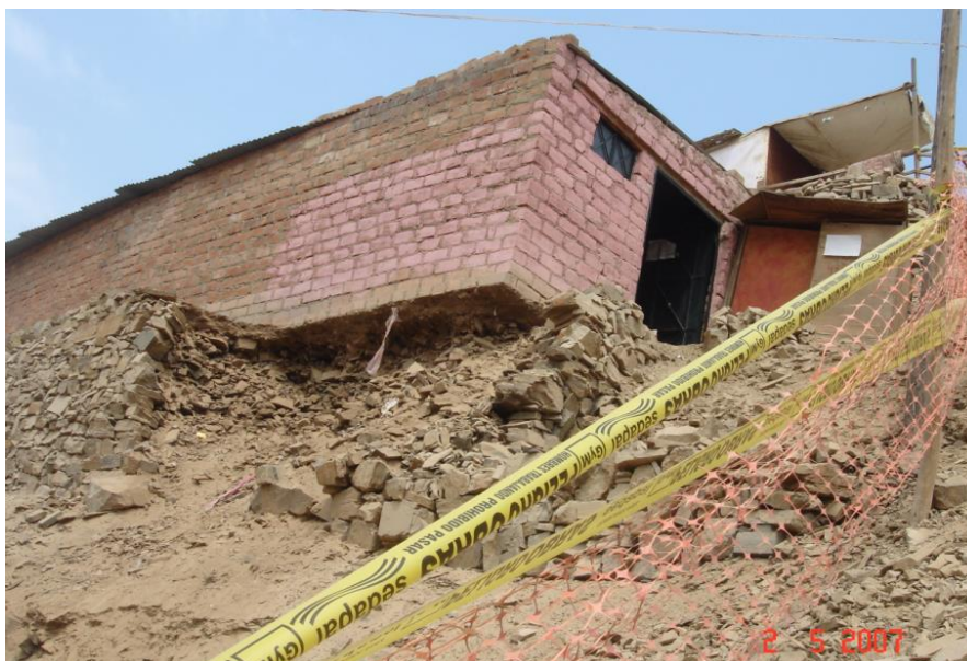
Figura 3.34: Vivienda siniestrada, Distrito de Puente Piedra.
