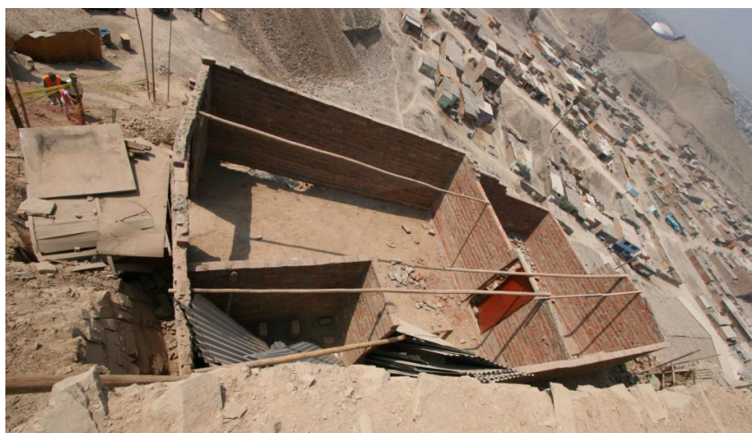
Figura 3.40: Características de la vivienda colapsada.
