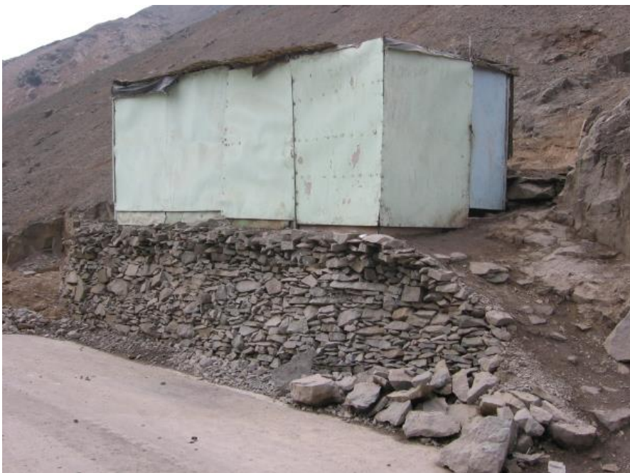
Figura 3.32: Cimentación con muro de piedra tipo pirca A. H. Villa 2000, Distrito de Ventanilla.
