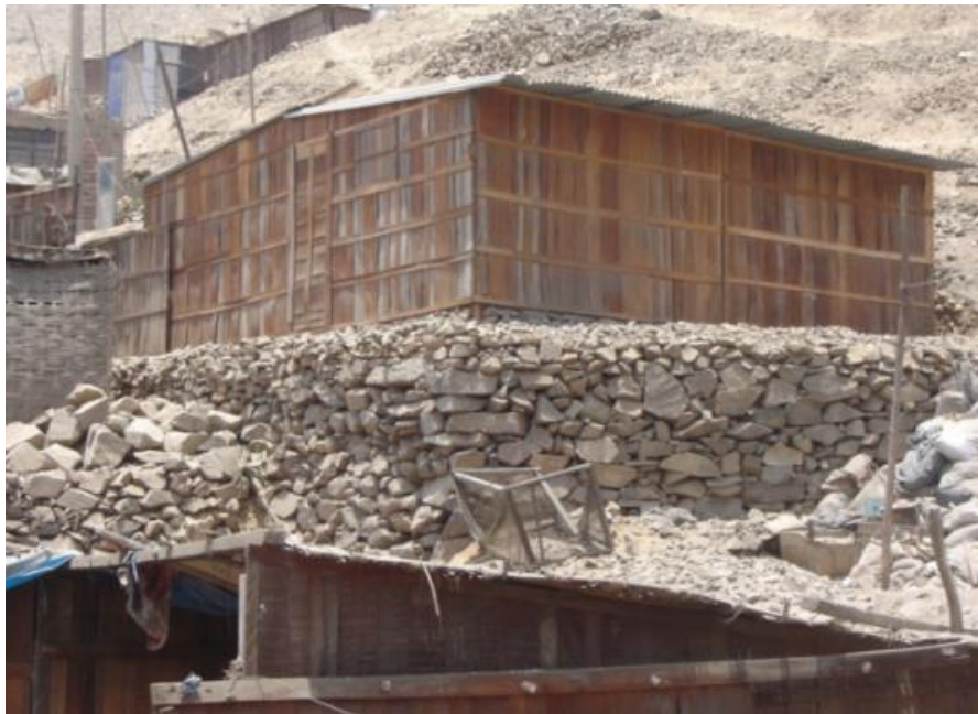
Figura 3.8: Cimentación con muro de piedra tipo pirca A. H. Huaycan, Distrito de Ate Vitarte.
