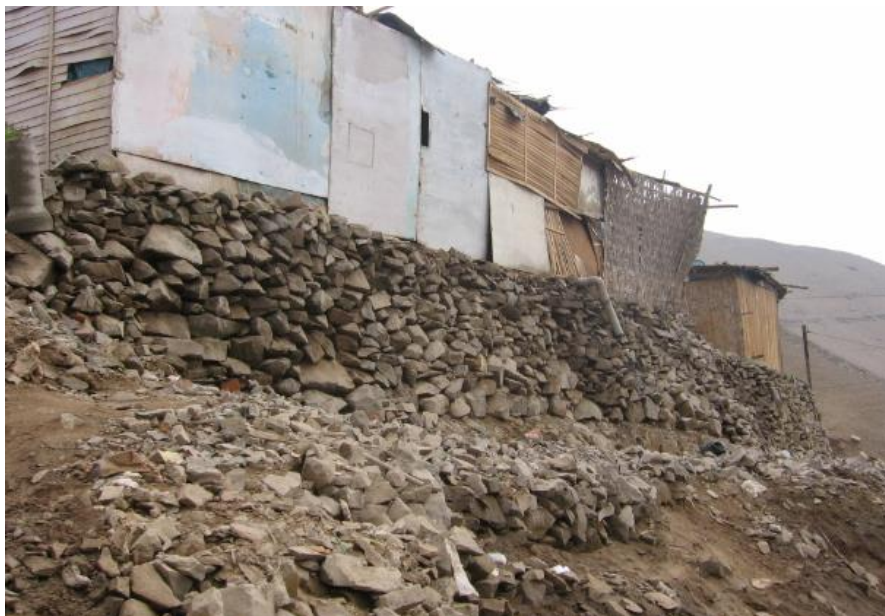
Figura 3.30: Cimentación con muro de piedra tipo pirca A. H. Villa 2000, Distrito de Ventanilla.
