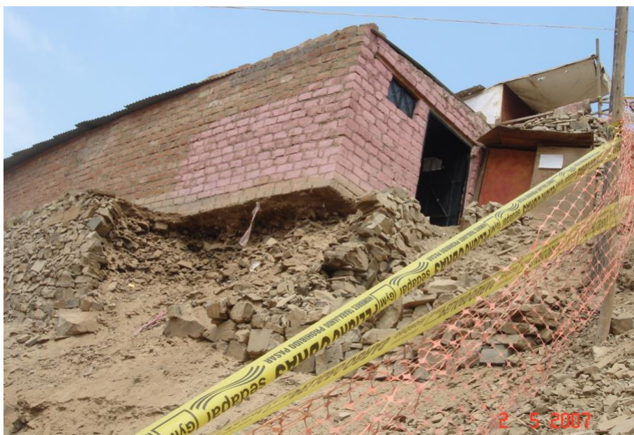
Figura 1.2: Vivienda colapsada en A. H. María Jesús Espinoza, Cerrito La Libertad, Distrito de Puente Piedra.
