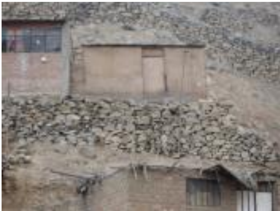
Figura 3.16: Cimentación con muro de piedra tipo pirca A. H. El Sauce, Distrito de San Juan de Lurigancho.
