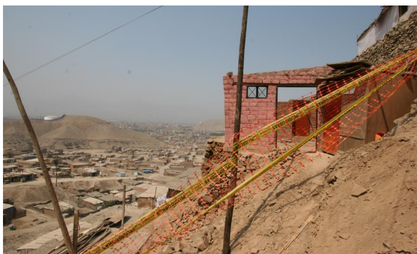
Figura 3.41: Frente de la vivienda colapsada.
