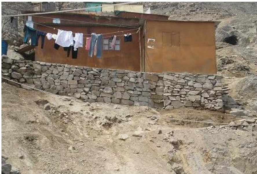
Figura 3.20: Cimentación con muro de piedra tipo pirca A. H. Los Alamos, Distrito de San Juan de Lurigancho.
