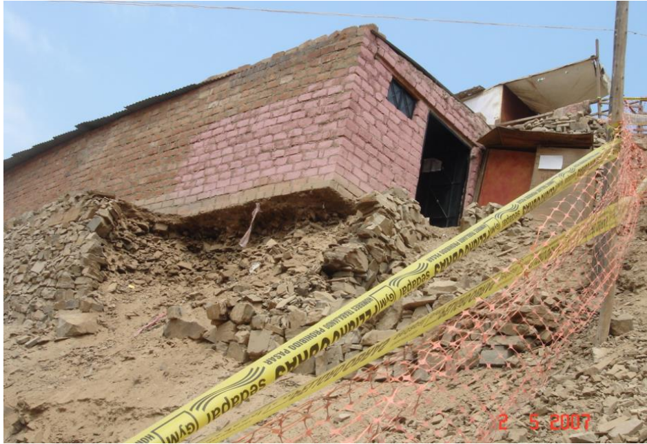
Figura 3.37: Detalle de la zona de colapso.
