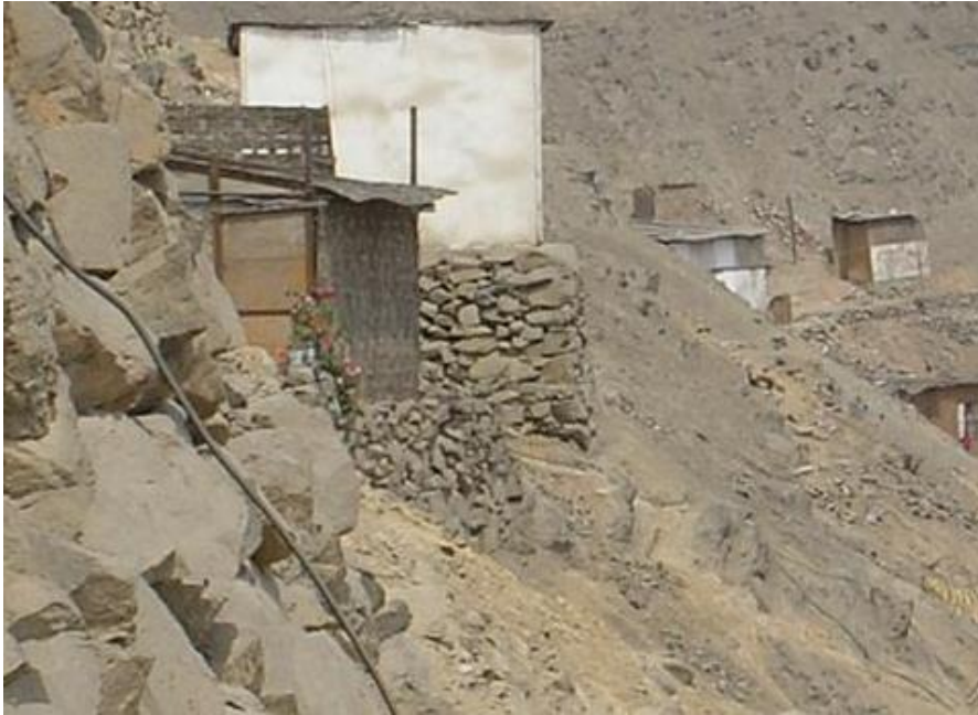
Figura 3.21: Cimentación con muro de piedra tipo pirca A. H. Los Alamos, Distrito de San Juan de Lurigancho.
