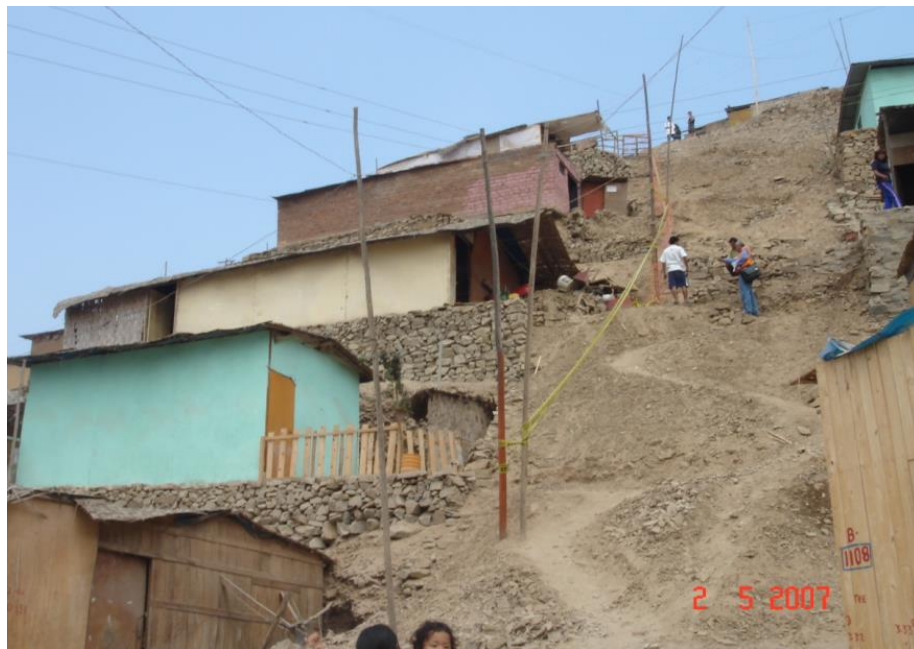
Figura 3.36: Zona del colapso en el Cerrito La Libertad.
